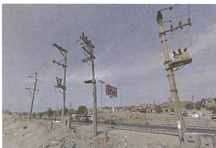
Fig. 4.17: Foto: Estado del PMI antes de los trabajos.
