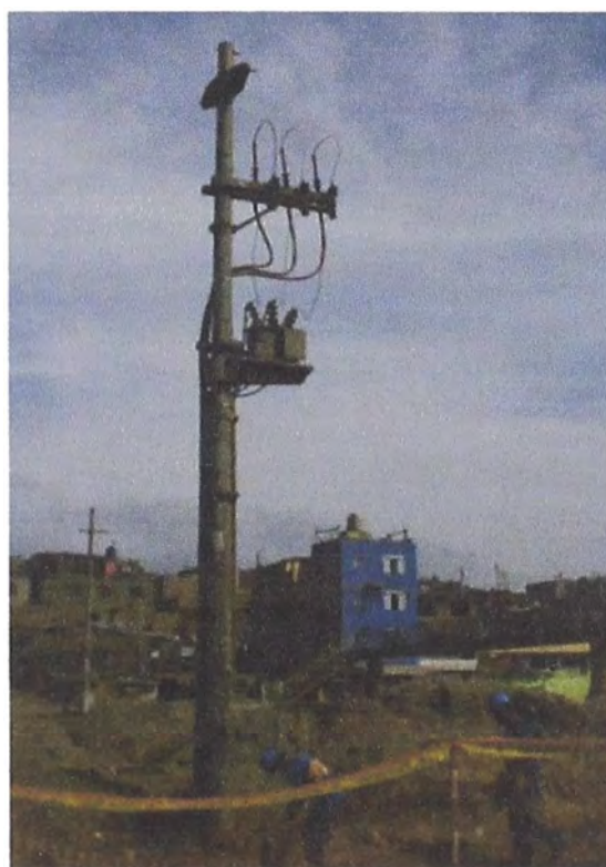
Fig. 4.25: PMI 911 con nuevo enlace subterráneo
