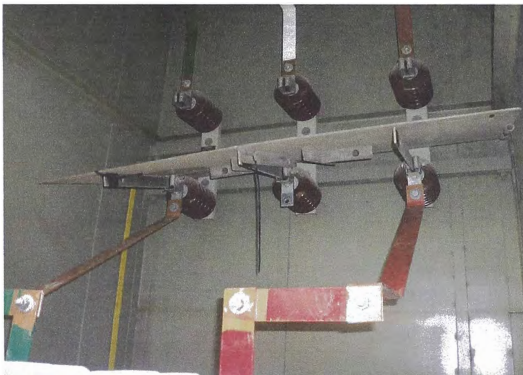
Fig. 4.17: Protector de barra colocado en celda
