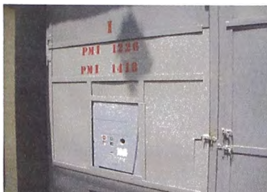
Fig. 4.20: Rotulado de celda
