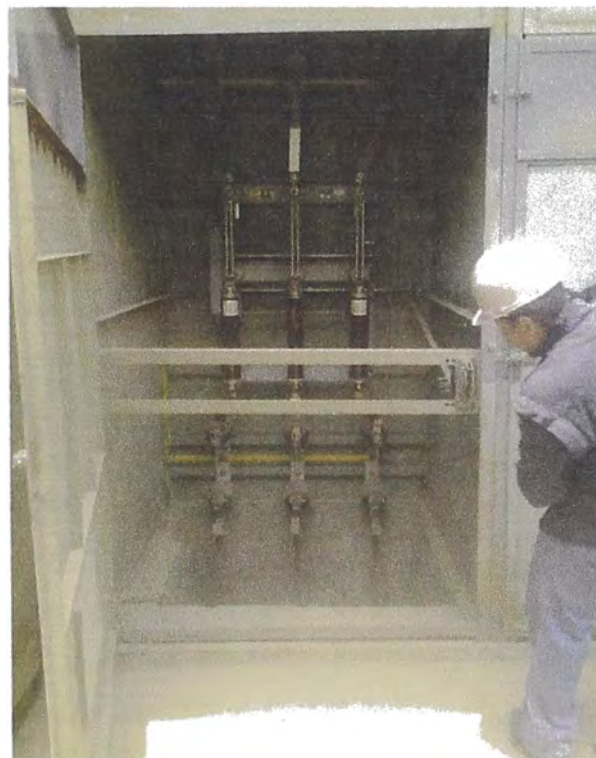
Fig. 4.18: Desconexión de las pletinas de cobre y sujeciones del seccionador
