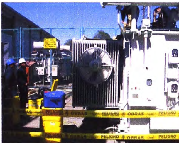
Figura 4.10 Pruebas del transformador
