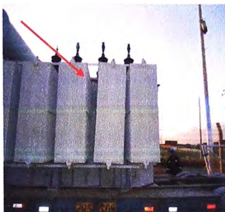
Figura 4.12 Se observa que el radiador N° 04, estaba inclinado, debido a que el colector se encontró torcido
