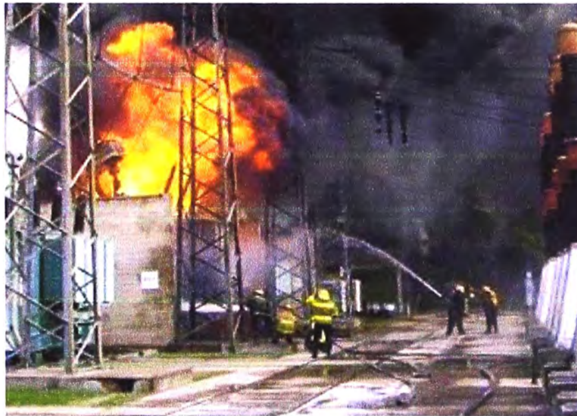
Figura 2.9 Incendio en un transformador debido a una falla
