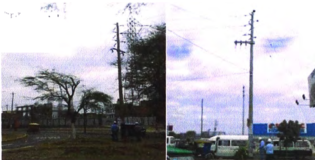
Figura 1.10 Recloser R12 y R4 (Fuente: Elaboración Propia)
