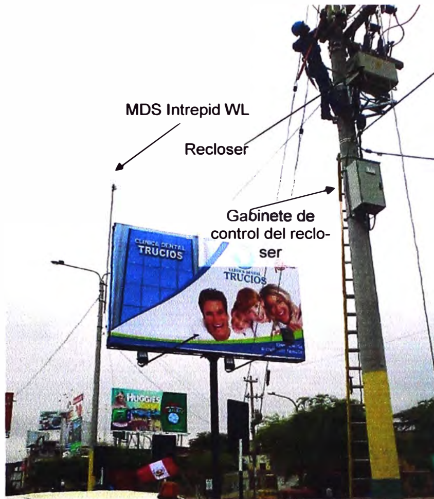
Figura 3.23 Punto del Recloser R4 (Fuente: Elaboración propia)
