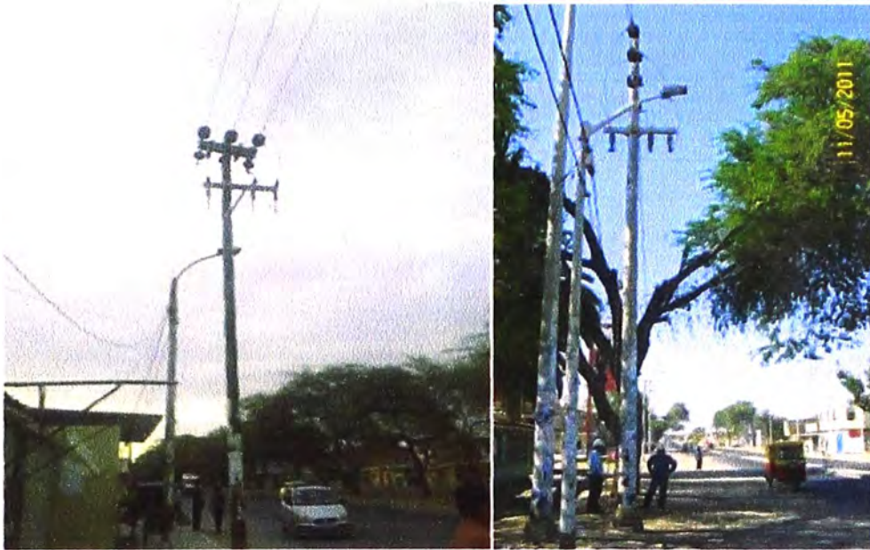
Figura 1.6 Recloser R9 y R14E(Fuente: Elaboración Propia)
