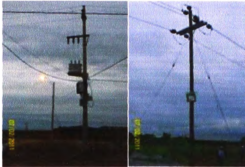
Figura 1.13 Recloser R36 y R37A (Fuente: Elaboración Propia)
