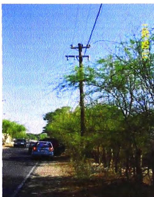
Figura 1.11 Recloser R44A (Fuente: Elaboración Propia)
