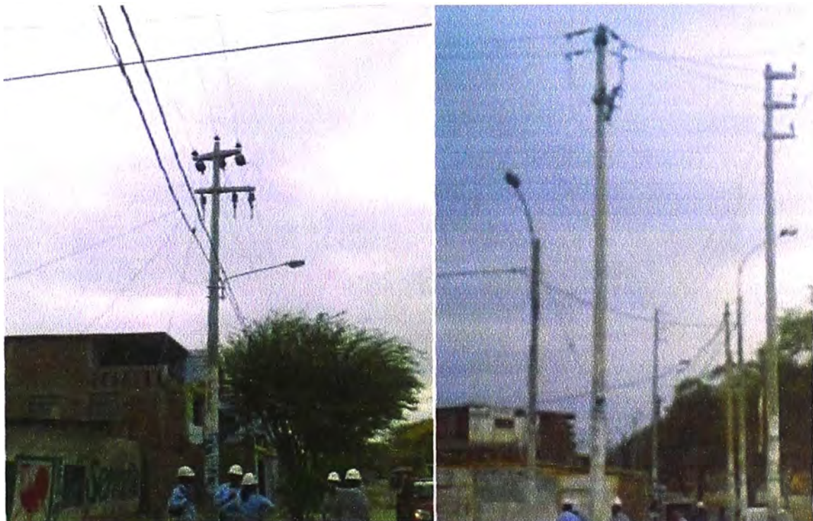
Figura 1.5 Recloser R7 y R8 (Fuente: Elaboración. Propia)
