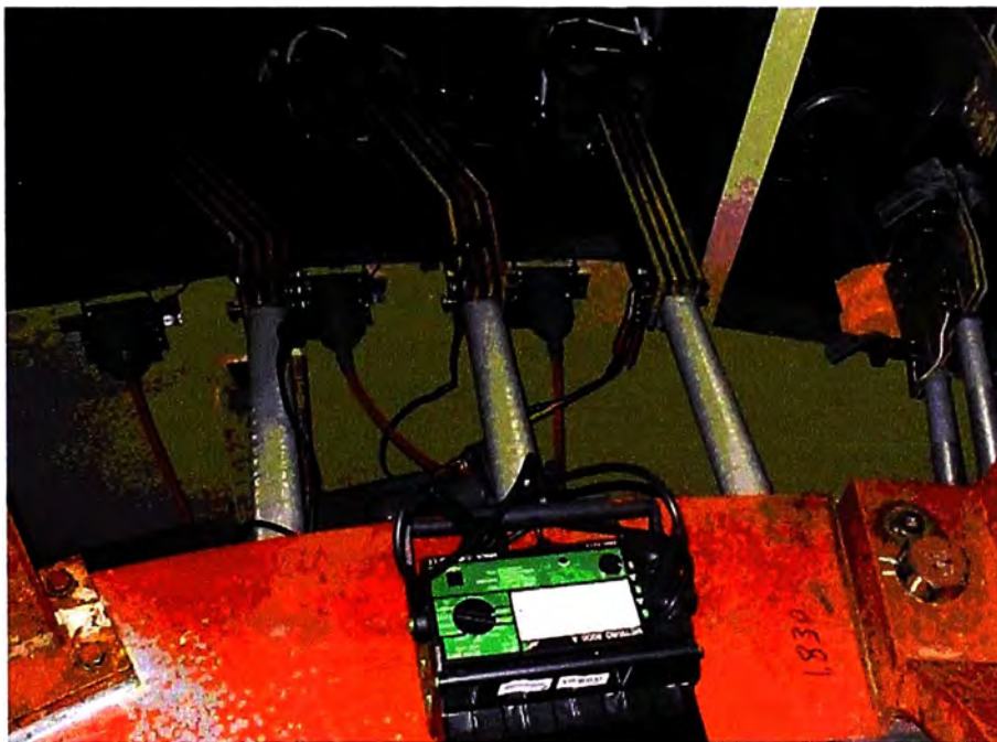
Fig. 3.2 Conexión del equipo de medición de Resistencia de Aislamiento e IP
