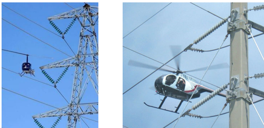
Figura 1.1: Labores de mantenimiento e inspección de tendidos de alta tensión desde un vehículo aéreo. Para mayor información visitar http://www.fkec.com/ .
