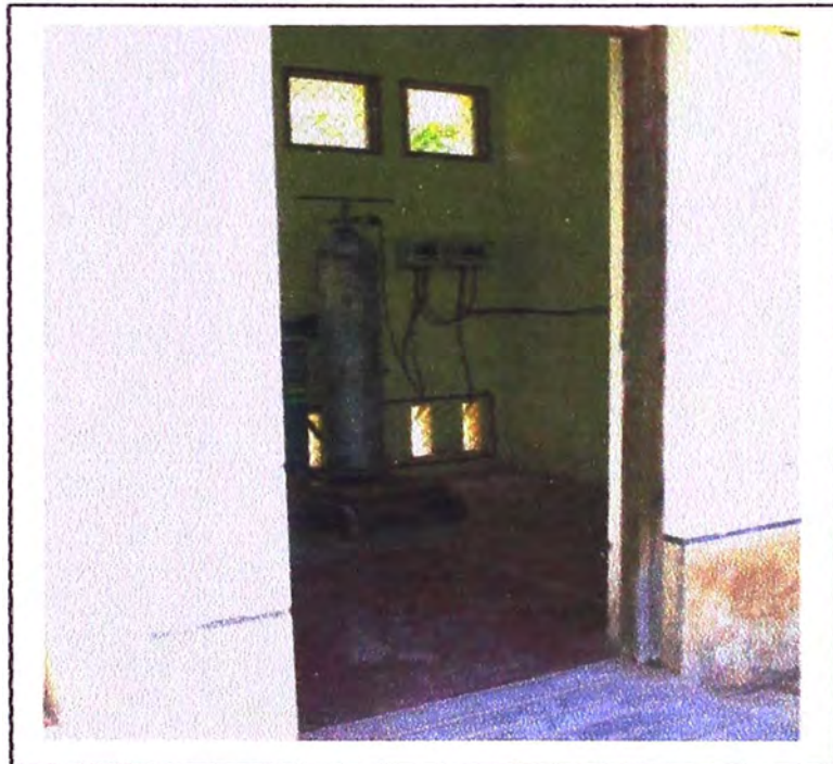
Fotografía N°7: Caseta de dosificación de cloro gaseoso en la planta de tratamiento San Mateo
