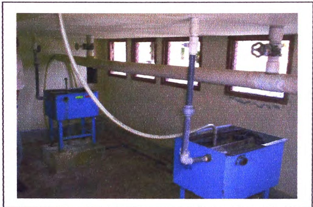
Fotografía N°6: Caseta de dosificación de reactivos químicos
