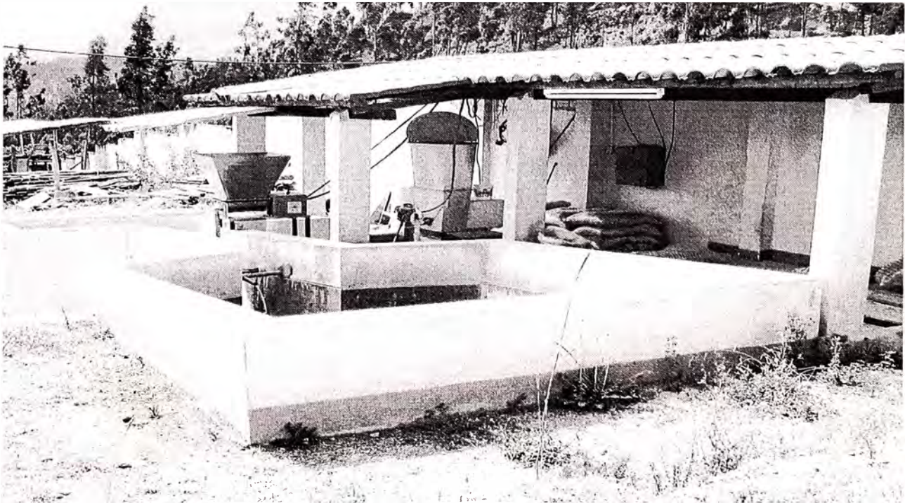
Vista total del Canal Parshall y del dosificador del Sulfato de Aluminio.
