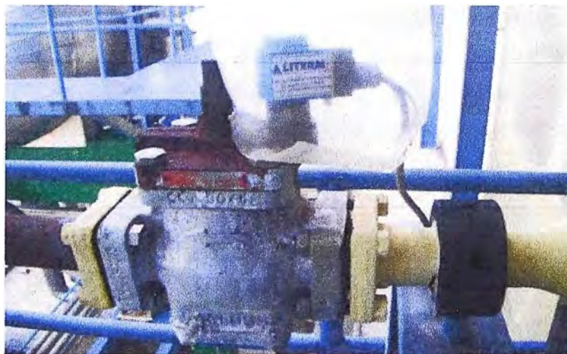
Figura 2.8 Válvula solenoide ON/OFF ingreso de NH 3 al separador (Fuente: Elaboración propia)
