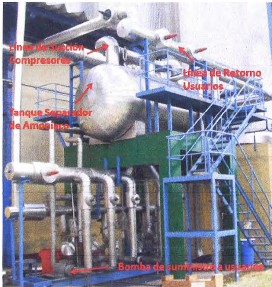
Figura 1.8 Tanque separador de Amoníaco (Fuente: Elaboración propia)
