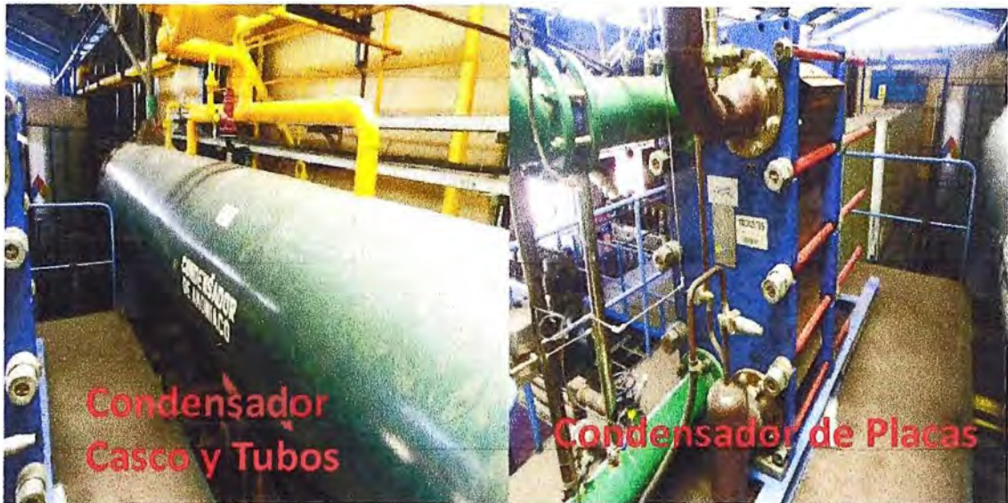
Figura 1.4 Condensadores del sistema de refrigeración
