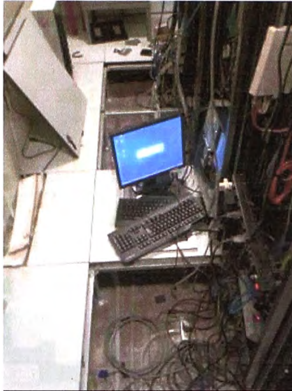
Figura 6.4 – Cableado eléctrico por debajo del piso técnico
