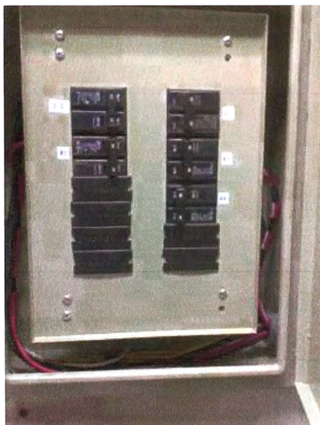
Figura 6.2 – Tablero complementario de cargas críticas
