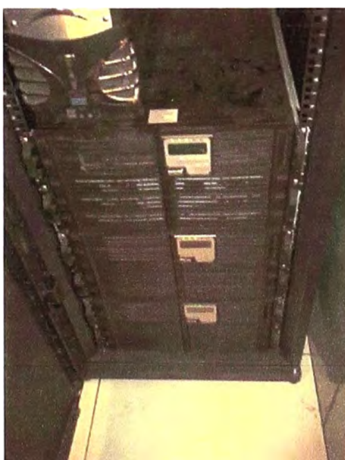
Figura 6.4 – Solución UPS marca Minute Man instalada
