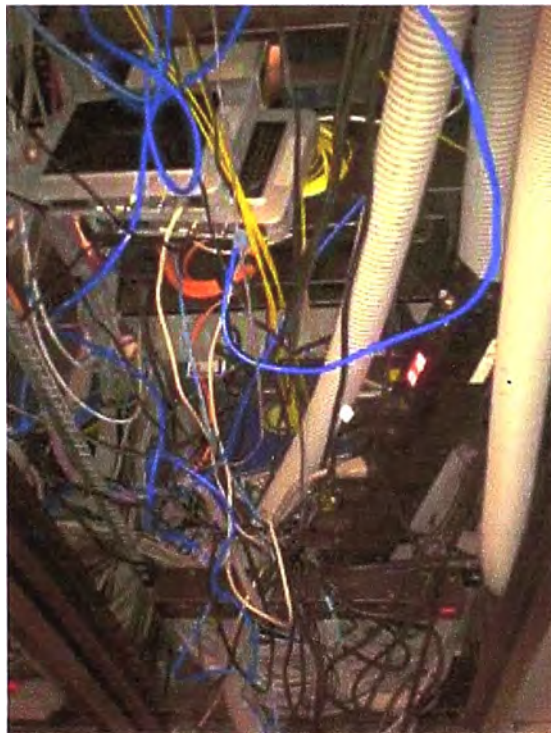
Figura 6.5 – Cableado eléctrico dentro de los gabinetes de equipos
