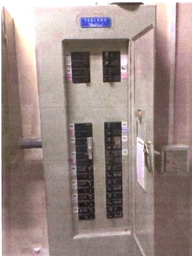
Figura 6.1 – Tablero general del centro de datos
