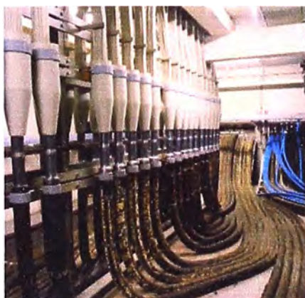
Fig.1.2: Galería de cables subterráneos
