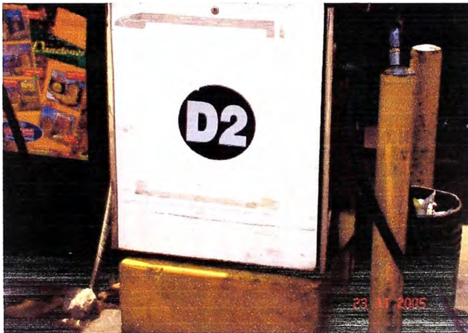
Foto N° 2. Surtidor con manguera de Diesel 2 enterrada.
