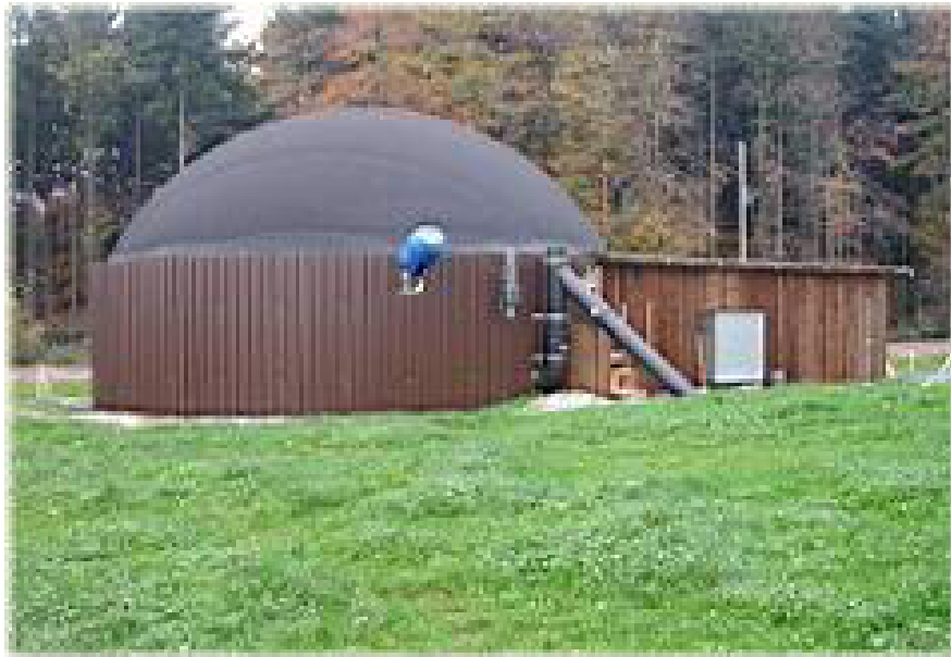
Figura 10. Biodigestor con tanque de almacenamiento tradicional y cúpula de Polietileno
