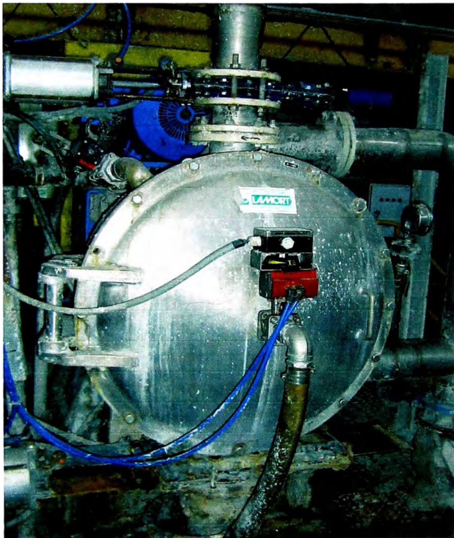
Foto N°13 Colador de Ranuras
