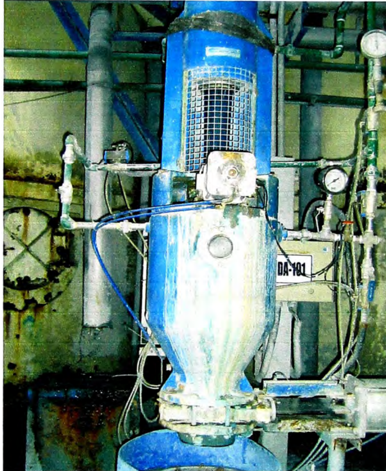
Foto N°8 Depurador de alta consistencia
