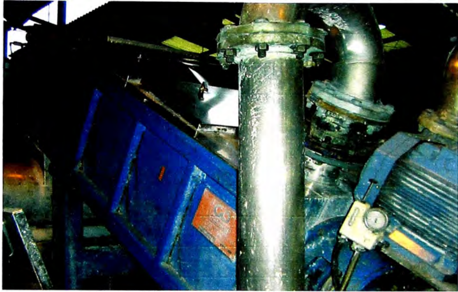
Foto N°19 Prensas seca vista frontal
