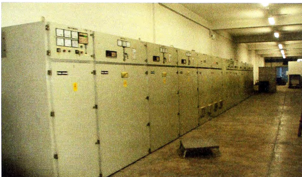
Fig.1.13 Tablero de arranque y bancos de compensación de los Compresores de NH3 en SSEE F
