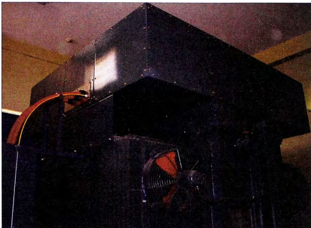
Fig.1.9 Transformador de la SSEE A (12/15 MVA)
