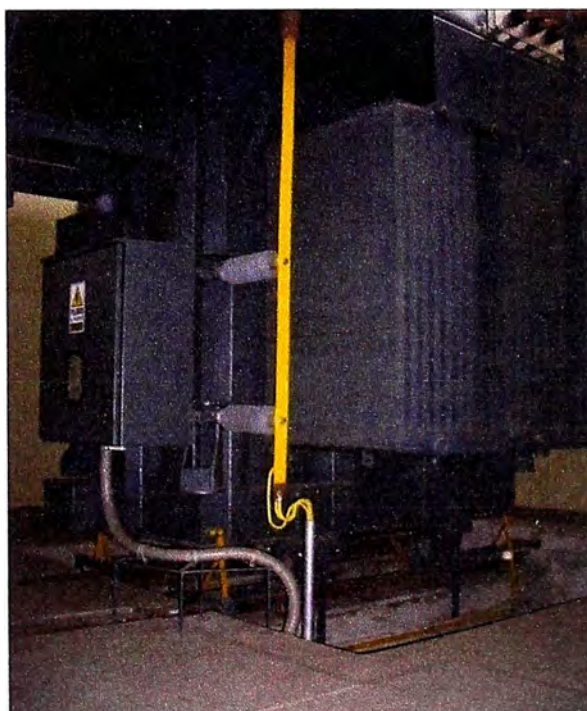
Fig. 1.8 Transformador de la SSEE A (12/15 MVA)
