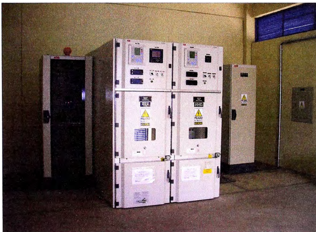
Fig.1.10 Interruptores primario y secundario del transformador de la SSEE A (12/15 MVA)
