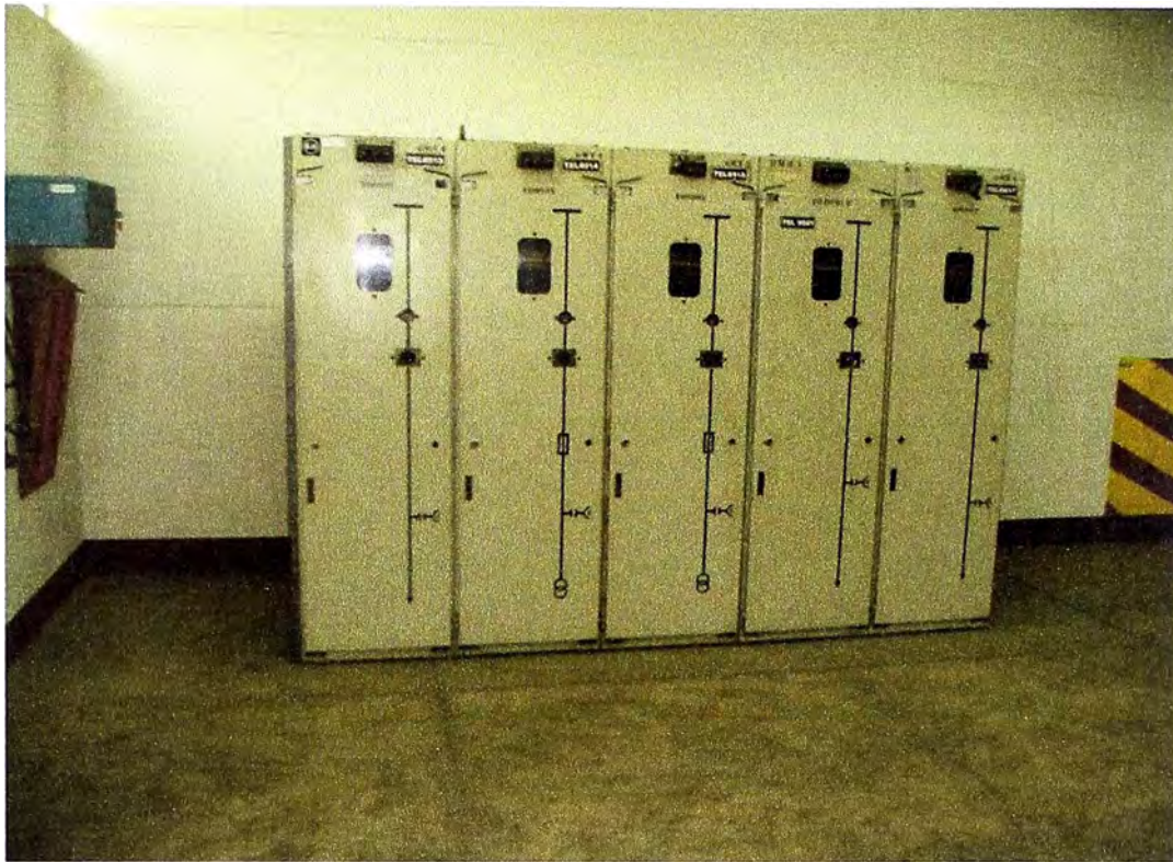
Fig.1.11 Celdas existentes en 10 KV
