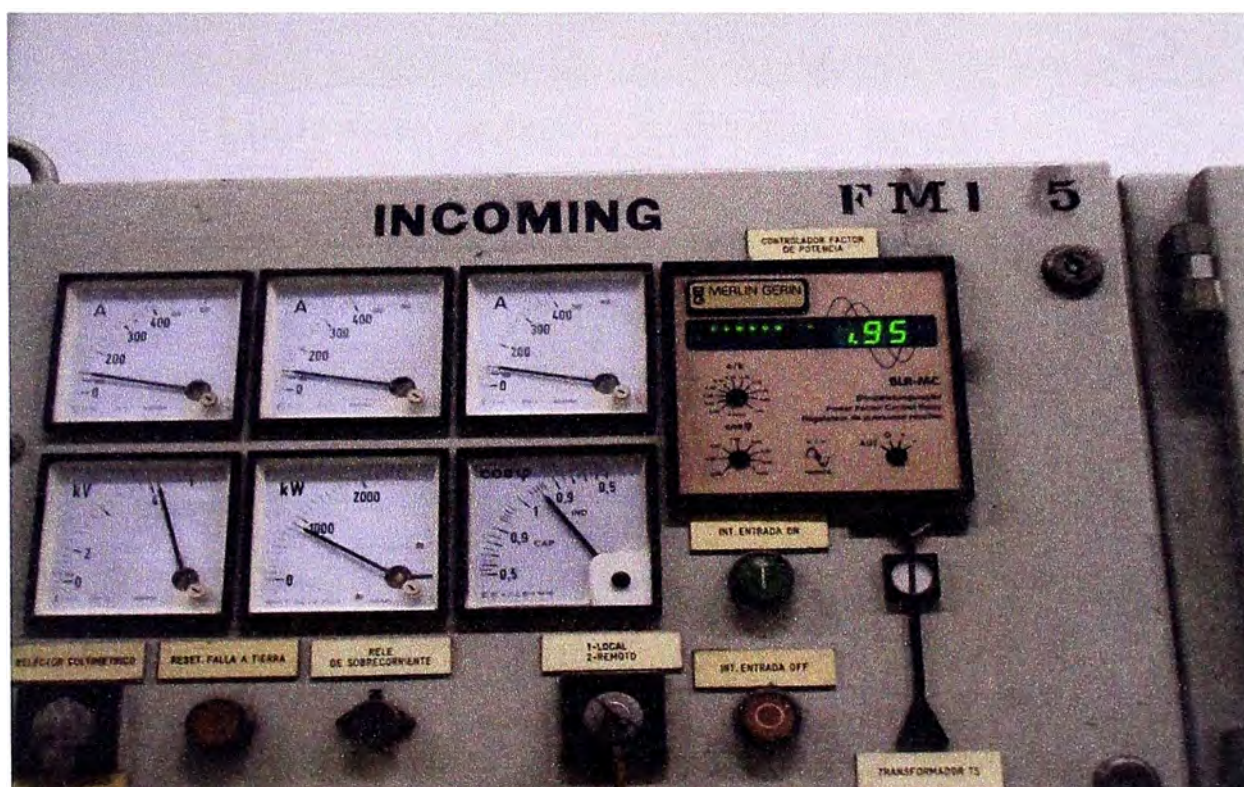
Fig.1.14 Cuadro de medición de los compresores de NH3
