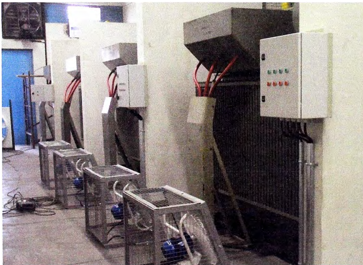
Fig.1.12 Transformadores FT1, FT2, FT5 y FT6 en la SSEE F
