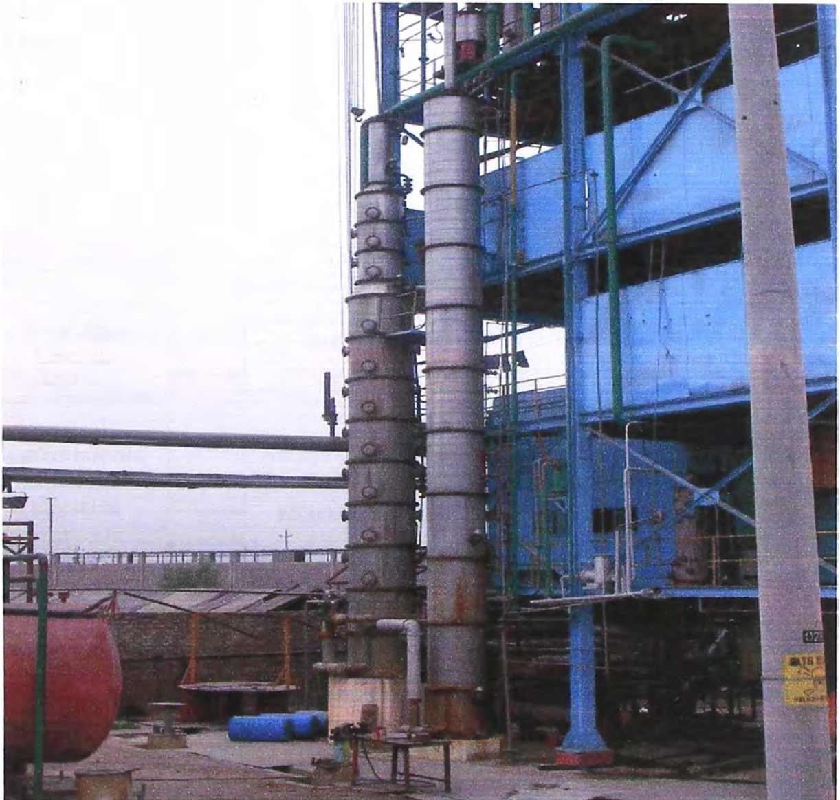
Figura N°14 : Sección de Destilación
