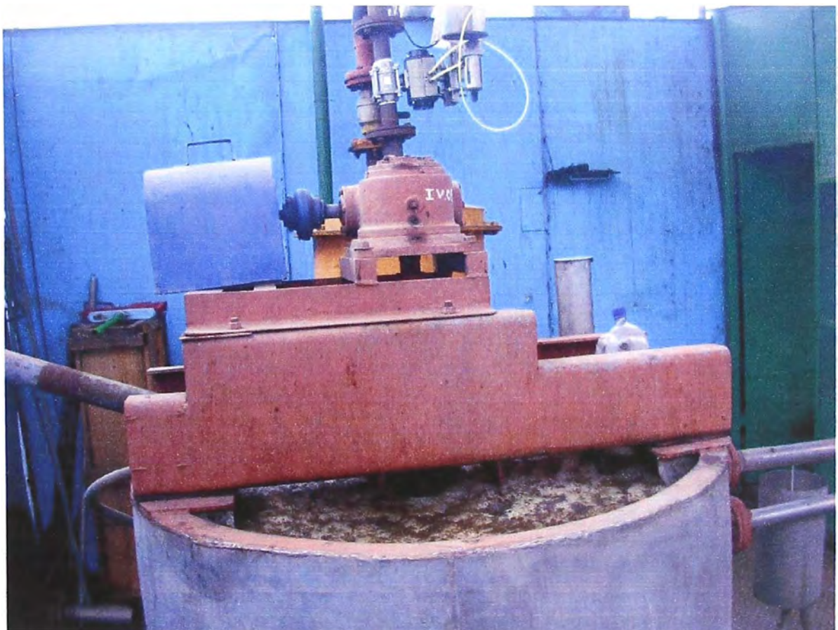
Figura N°10 : Tanque de Dilución
