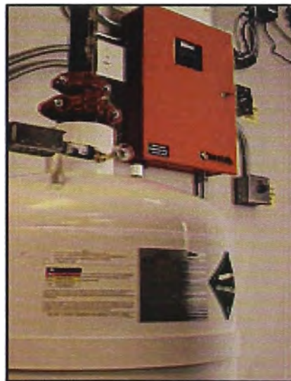
Fig.4.5 Sistema Contra incendios
