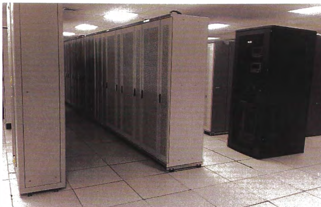
Fig.4.1 Sala de conmutación
