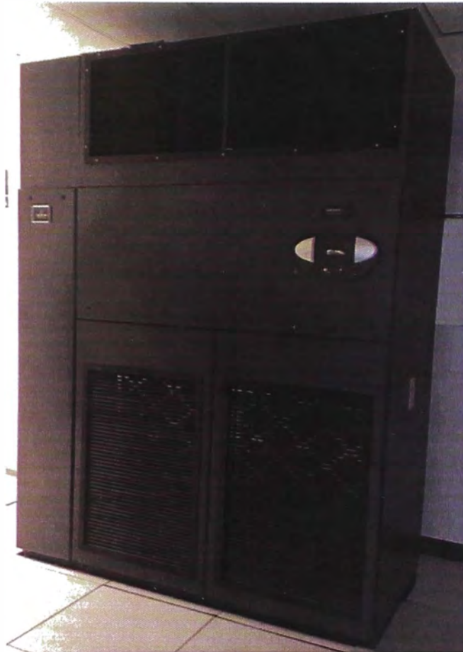
Fig.4.3 Equipo de aire acondicionado
