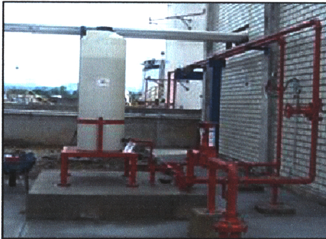
Fig. 2.11 Tanque de espuma de sistema contraincendios.
