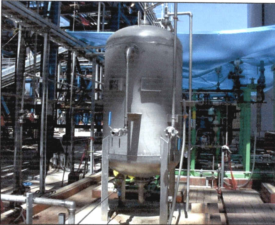
Fig. 2.8 Tanque de almacenamiento de amoníaco con soportes tipo ángulo
