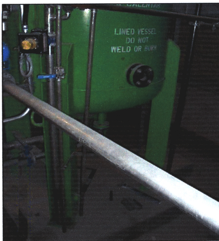
Fig. 2.7 Detalle de accesorios y soportes tipo columna
