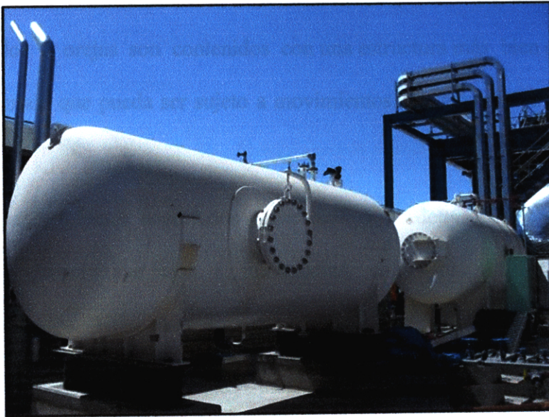
Fig. 2.9 Tanque de almacenamiento de amoniac con soportes tipo ángulo
