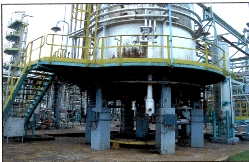
Fig. 2.12 Horno cilíndrico vertical soportado por columnas de acero. Fuente: Refinería Iquitos
