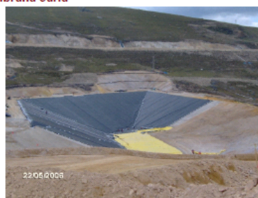
Avance de Cara Norte de Poza de Tormentas - colocacion de geomembrana 3aria
