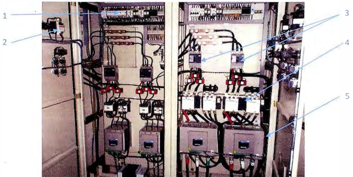
FIGURA B.6 TG estación CRP1B
