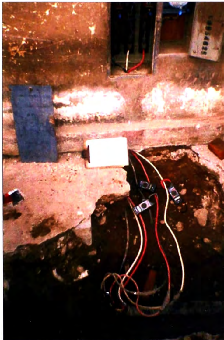
Figura 2.15 Conexión clandestina al cable matriz
