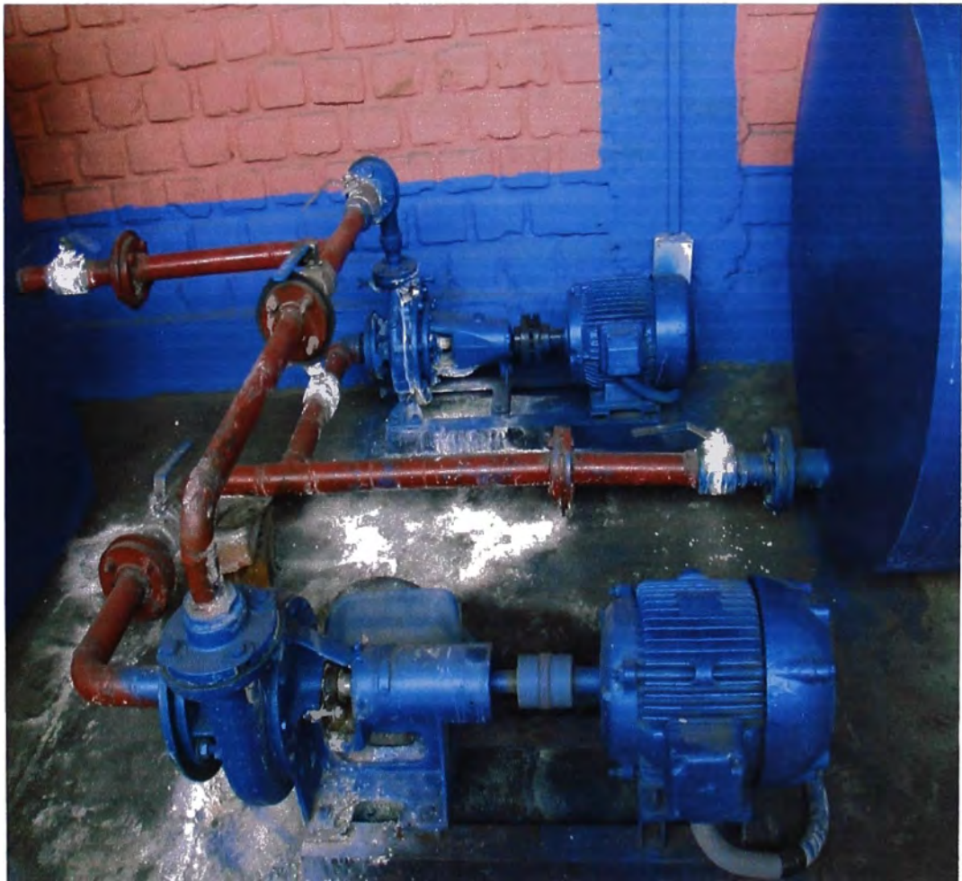
Fotos N° 11 . Bombas Centrífugas de Recirculación.
