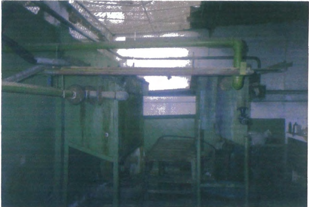
FOTO N° 10 CELDAS EN PARALELO EN FINESSE
