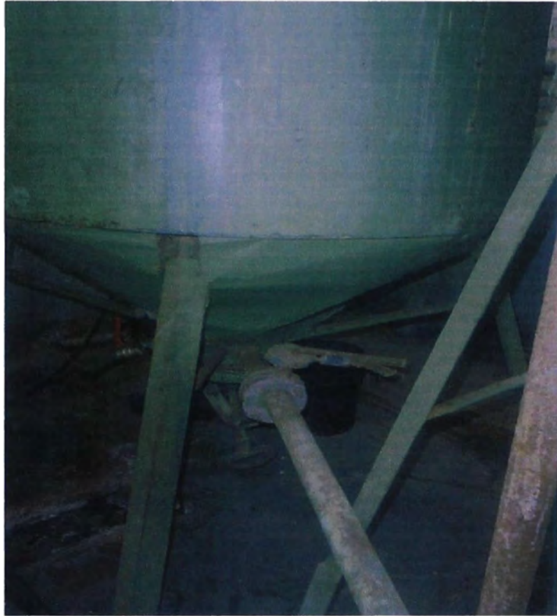
FOTO N° 4 DUCTO DE INGRESO DE SOLUCION
