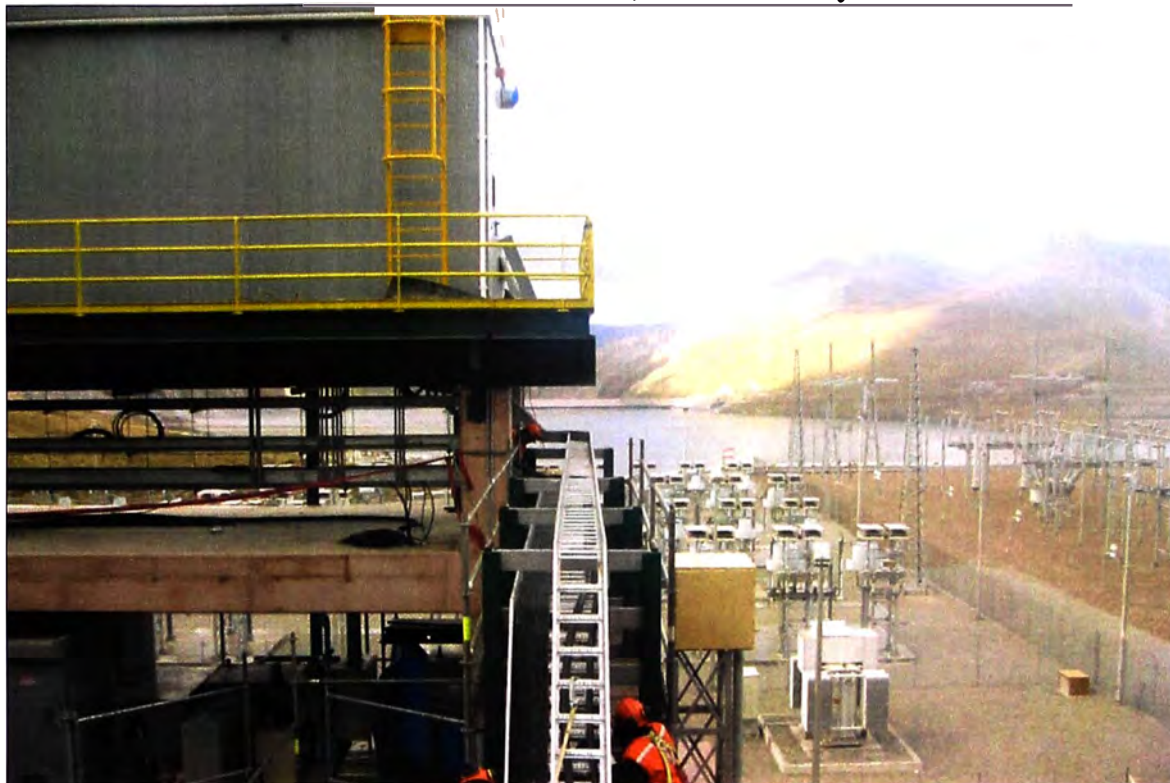
Foto 5 – Sala Eléctrica 317-EHU-171, Sub-estación y Canalizaciones
