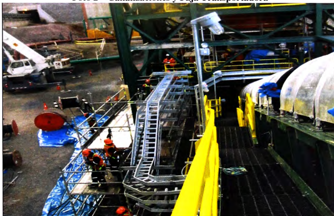
Foto 2 – Canalizaciones y Faja Transportadora
