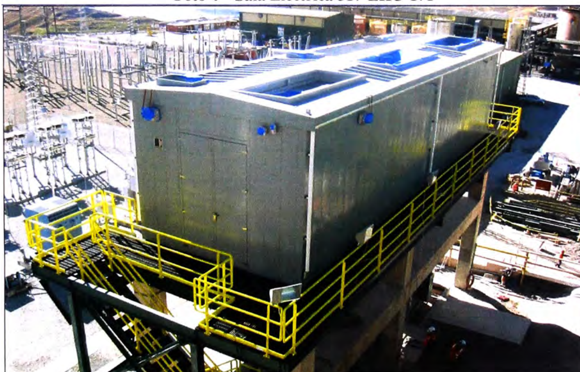
Foto 4 – Sala Eléctrica 317-EHU-171
