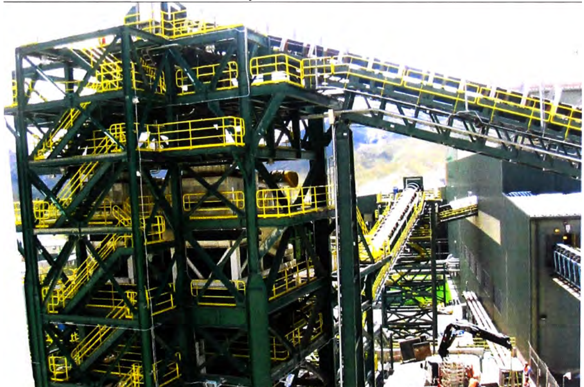
Foto 8 – Pararrayos, Torre de Zarandas Secas
