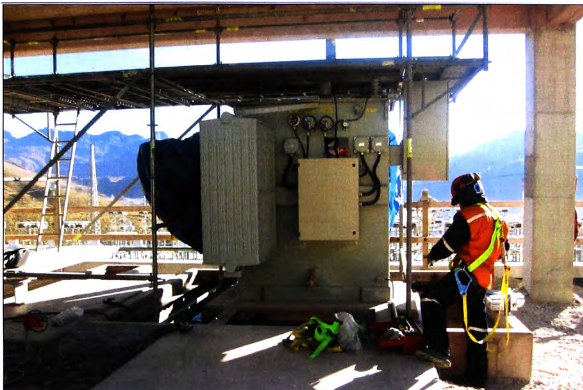
Foto 1 – Transformador de Potencia 317-XFU-172, 2 MVA, 4.16/0.48 kV
