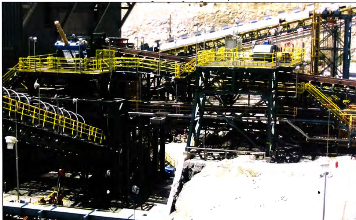
Foto 6 – Punto de desviación del mineral hacia el Proyecto (Tripper, Válvula Compuerta Fa'a 031)
