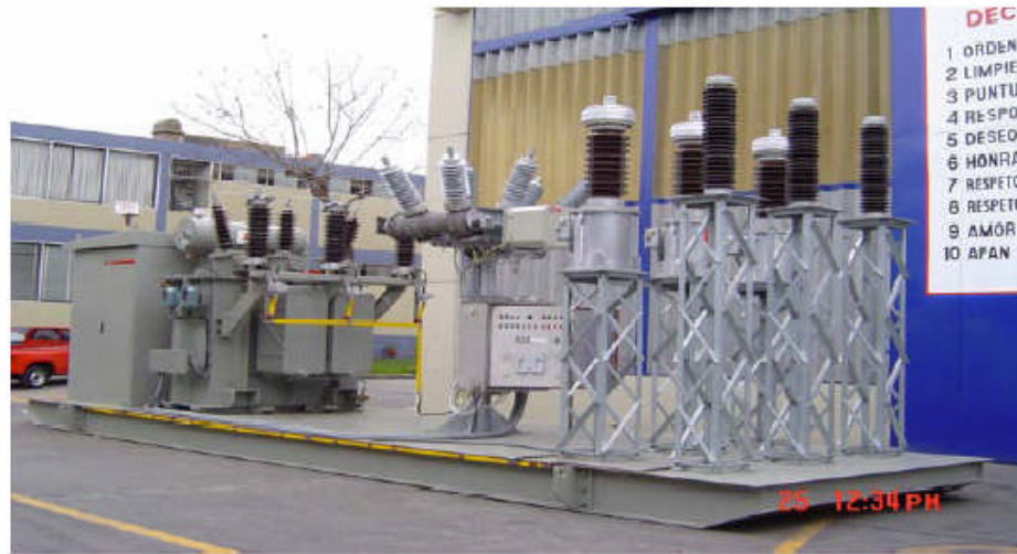
Sub-estación tipo patín con solución PASS – 60 KV : 4/5 MVA , 60/10 KV
