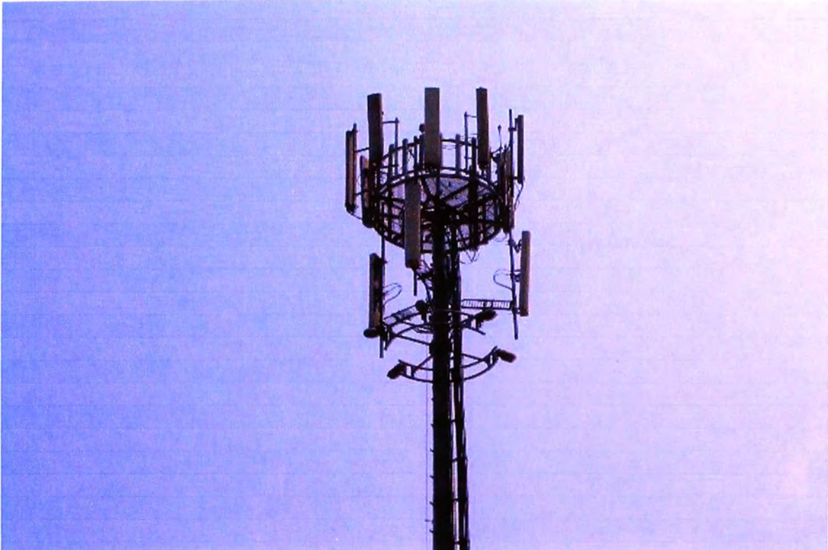
FIGURA 2.3 Estación Base Celular
