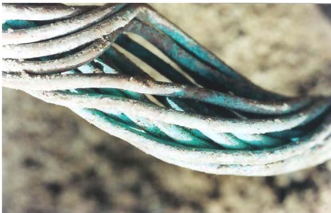
Foto 02. Doblez en Conductor de la Red de Puesta a Tierra para descubrir la situación de las hebras internas, que presentan una delgada capa de Sulfato de Cobre, manteniendo la superficie cubierta en buen estado.
