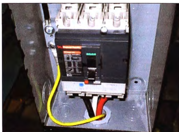
Figura 4.13 Conexión al grupo electrógeno
