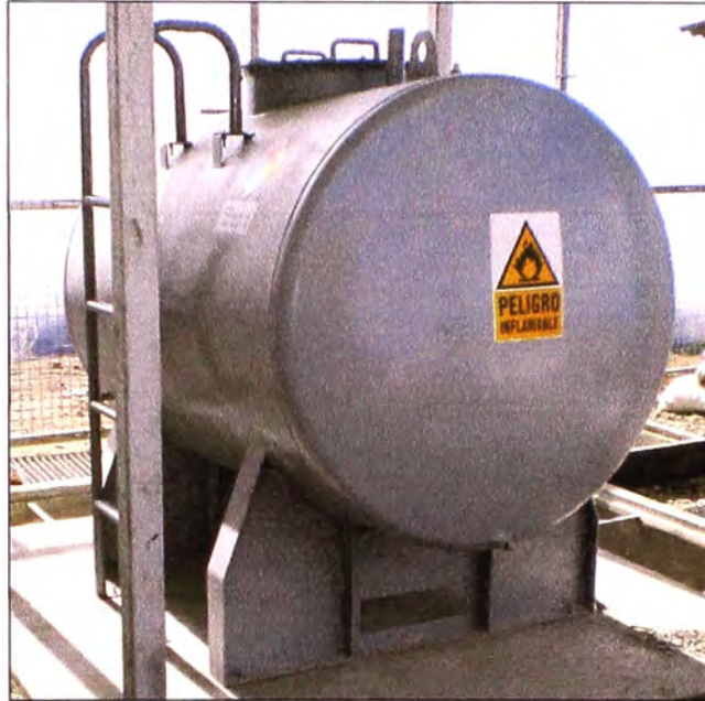
Figura 4.4 Tanque de almacenamiento de combustible
