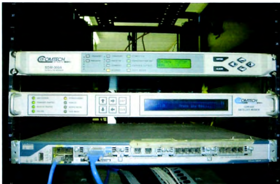
Fig. 3 Modem Satelital Router Principal. Campamento La Granja
