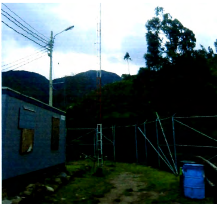
Fig. 4 Torre ventuada para soporte de antenas
