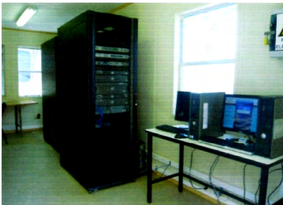
Fig. 2 Data Center campamento La Granja
