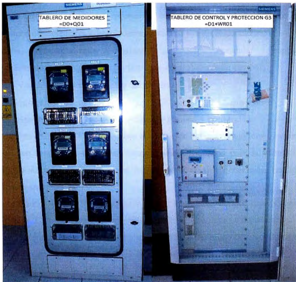
Fig. 2.1 Tableros de Control-Protección y medida del nuevo Campo Grupo G3
