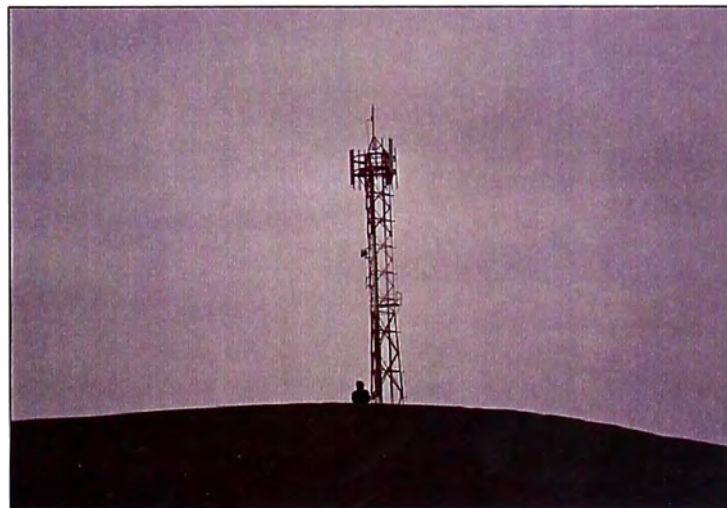
Fig. 2.7 EBC instalada sobre un cerro.
