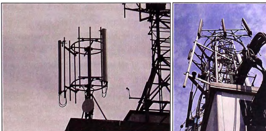
Fig.3.22 Ampliaciones de estructuras en torre para ganar altura con las antenas.
