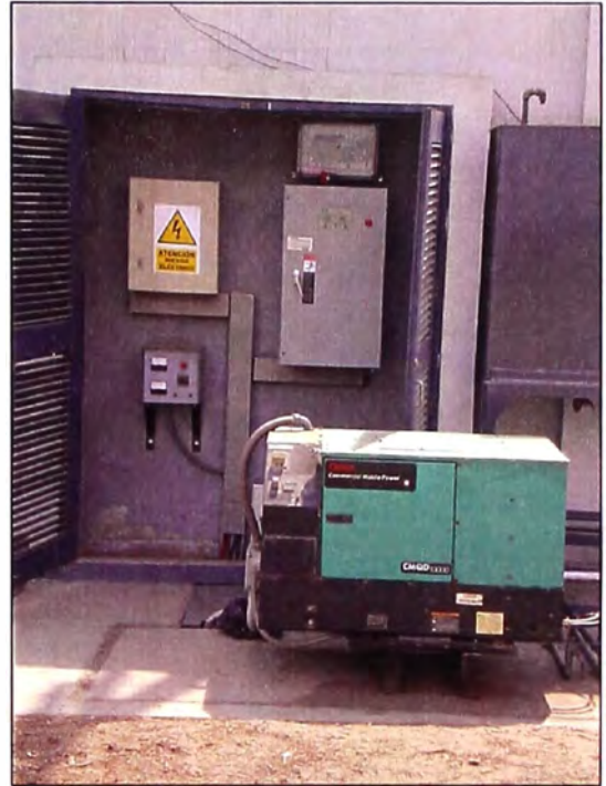
Fig.2.9 Grupo Electrónico instalado en una EBC ubicado en un cerro.
