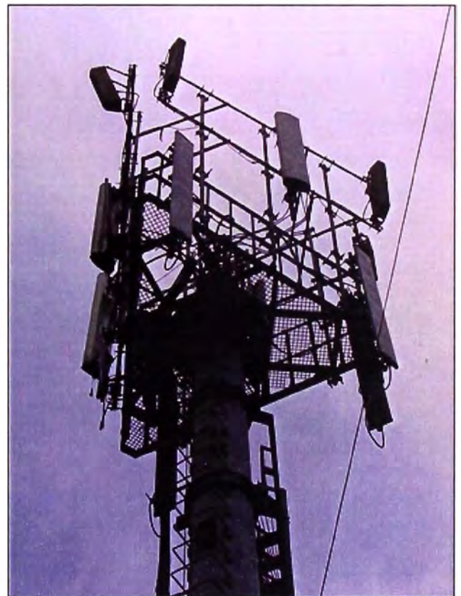
Fig.2.2 Torre celular tipo monopolo donde observamos antenas sectoriales de las distintas tecnologías además de las antenas microondas para las transmisiones; aquí ya no hay espacio para instalar las antenas GSM.
