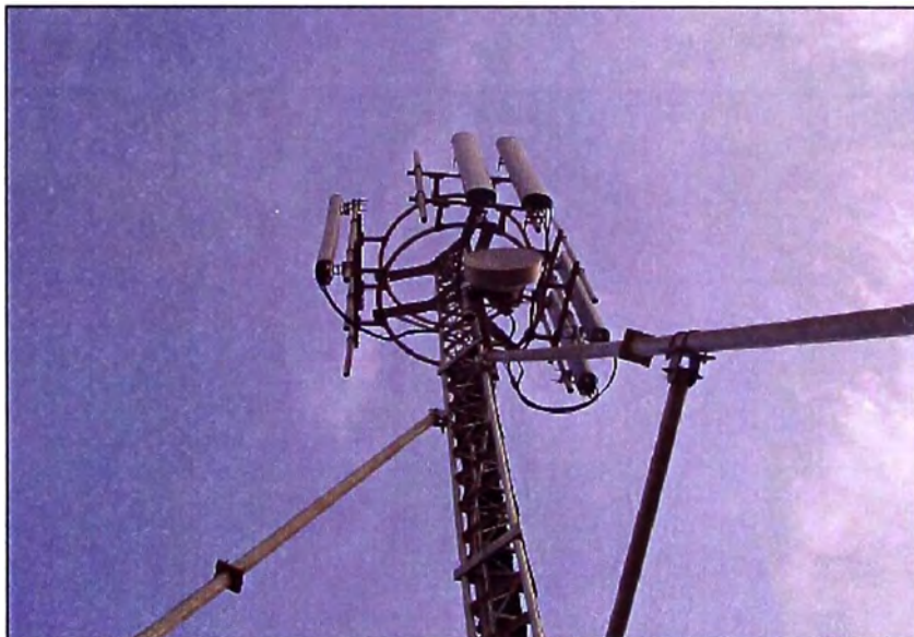
Fig.1.6 Antenas sectoriales y microondas.
