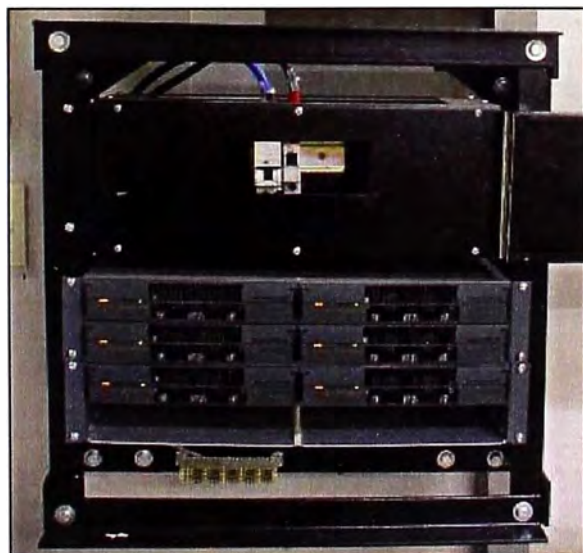
Fig.3.1 Conversores ELTEK, que proveen -48V DC necesarios para energizar los equipos Indoor GSM.
