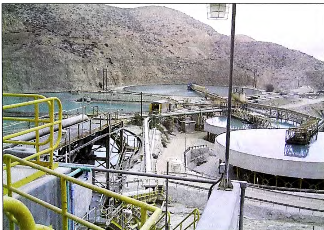
FIGURA 2.2 Planta de relaves actual
