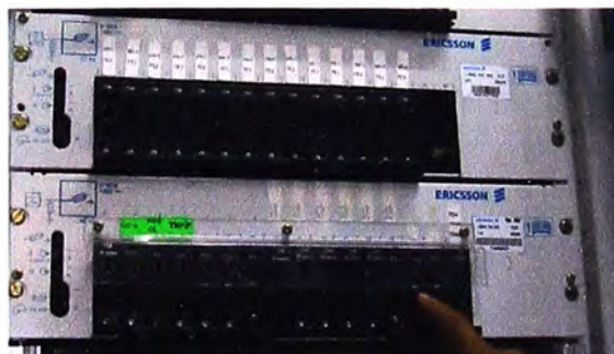
Figura 3.9 Verificación de llaves de alimentación
