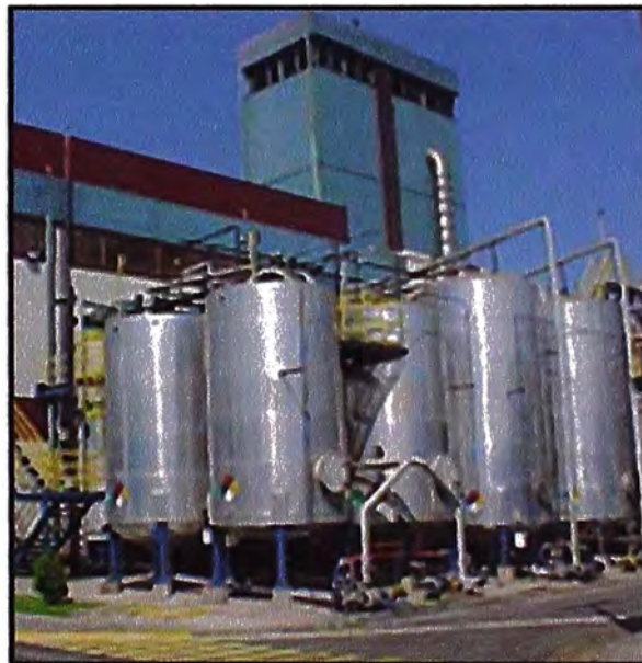
Figura 11. Tanques de Almacenamiento de Aceite
