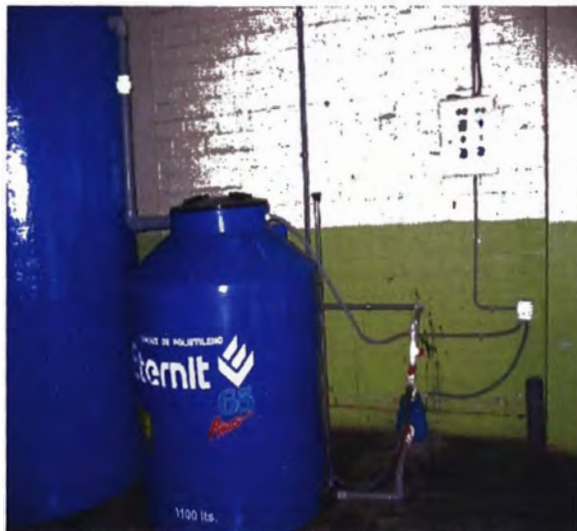
Unidad de bombeo del agua tratada: Retorno a la sección vibrado.
