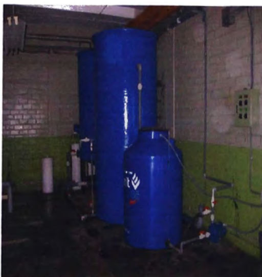
Planta de tratamiento: Floculador, filtro y tanque de agua tratada.
