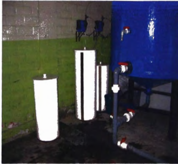
Detalle de bombas dosificadoras y zona inferior del floculador.
