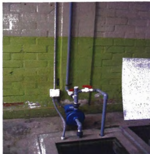
Cámara de bombeo: líneas hacia planta de tratamiento.
