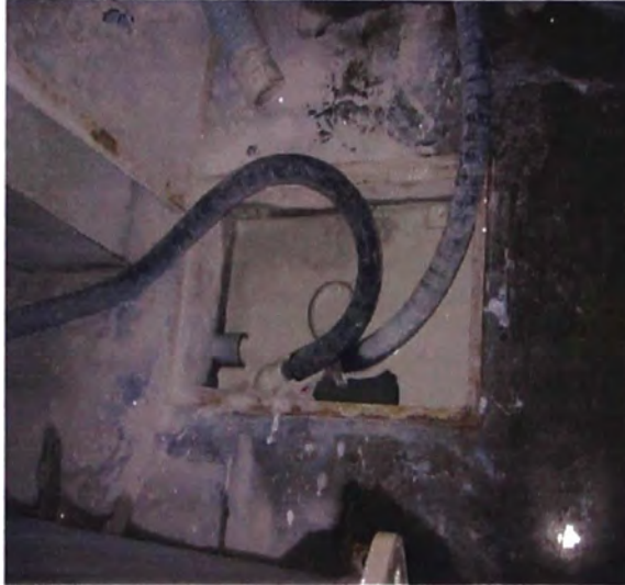
Buzón de descarga directa, de máquinas vibradoras, línea 2
