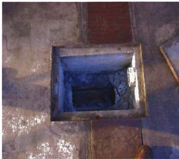
Buzón Nº2: Línea de vibrado Nº1.
