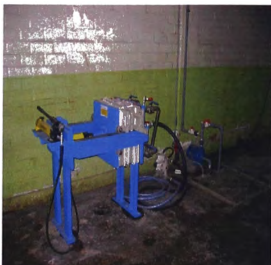
Unidad de prensado de lodos: Filtro prensa.
