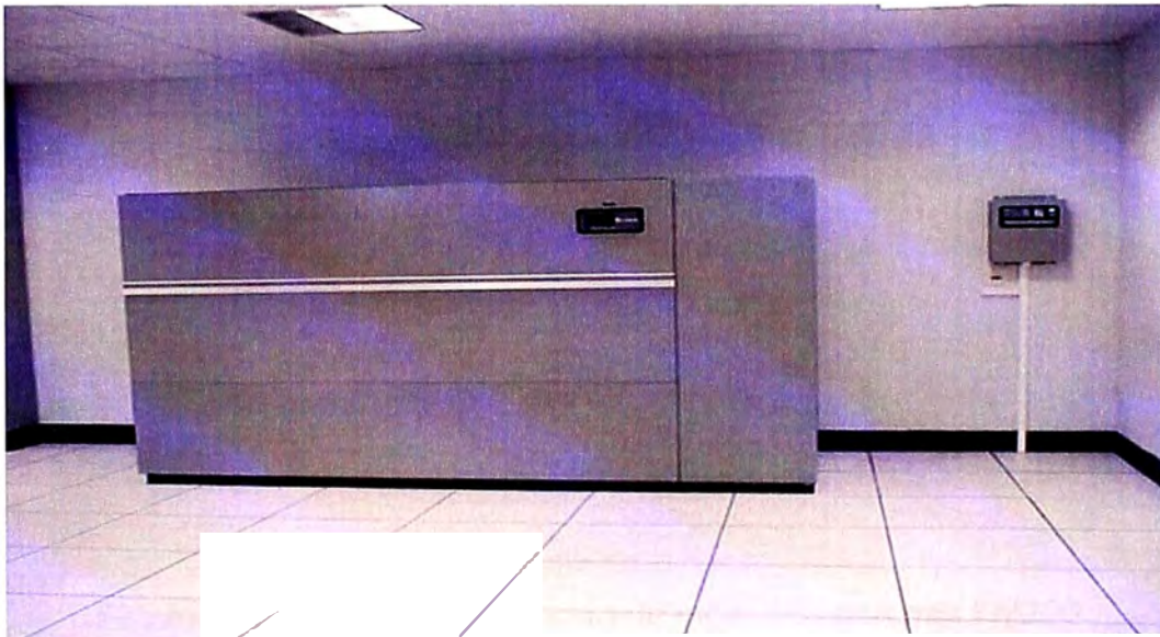
Figura 2.4 Equipos de Aire Acondicionado Liebert
