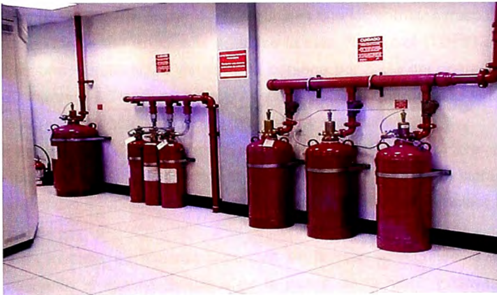
Figura 2.5 Sistema de extinción de incendios con gas FM200
