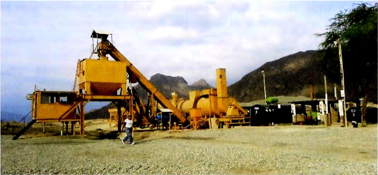
Figura N° 3.1 Planta Procesadora de Asfalto
