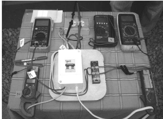
Fig. 3.15.- Tablero de Conexiones con Instrumentos de Medida
