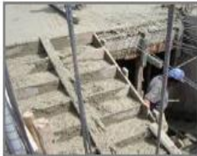
Incorrecto: Vaciado de arriba abajo.
