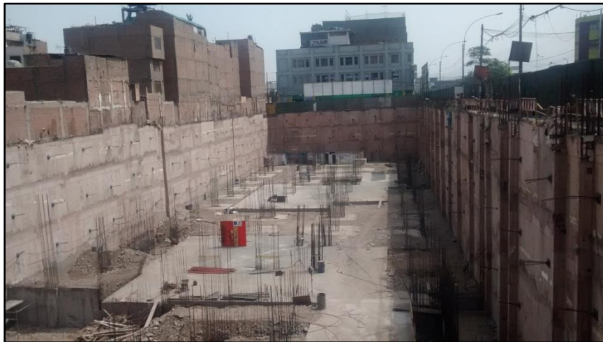
Figura N° 13: Vista panorámica de la situación del proyecto (Fuente: Fotos tomadas en la obra CCH)
