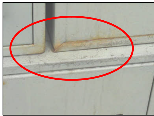
Figura 3.30. Oxido en cajas de almacén
