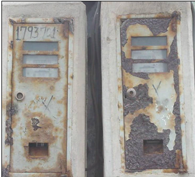
Figura 3.28. Cajas metálicas en el final de su vida útil.
