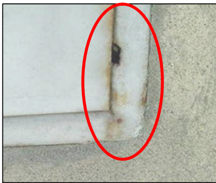
Figura 3.29. Corrosión en bordes
