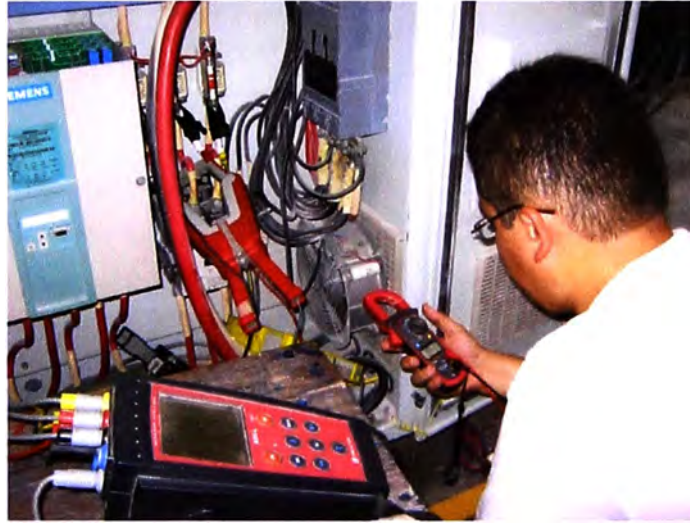
Fig. 3.4 Medición de armónicas en el convertidor AC/DC de 75kW
