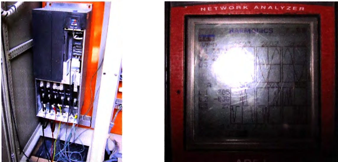
Fig. 3.5 Medición de armónicas en el convertidor AC/AC de 55kW
