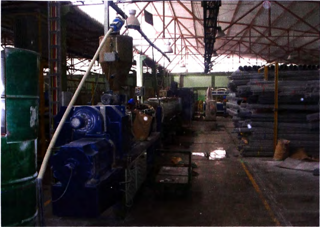
Vista general de equipos en 440Vac de la planta
