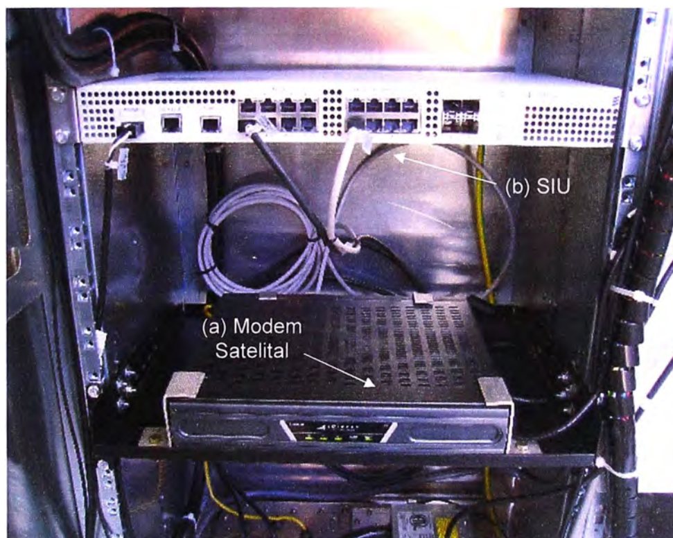
Figura 3.12 a) modem de enlace satelital y b) tarjeta SIU. Instalación y conexionado de modem satelital i-Direct y SIU marca Ericsson. (Fuente: Propia)
