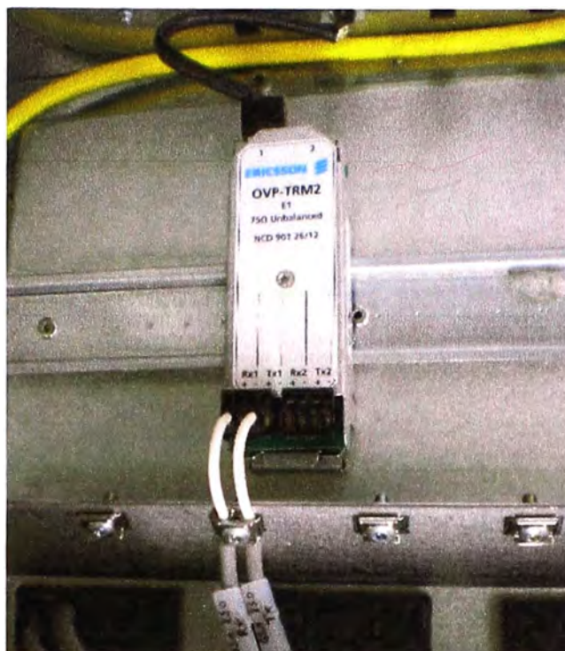
Figura 3.11 OVP (Over Voltage Protection). Protección del E1 contra sobre voltajes (Fuente: Propia).
