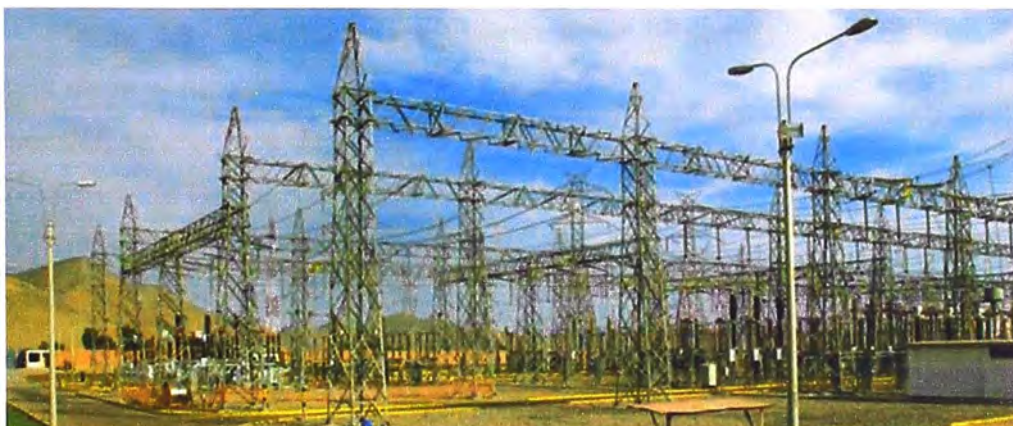
Figura 3.5 Vista general de la Subestación Chilca REP (Fuente: Ref. [8])
