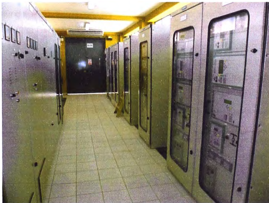
Figura 2.7 Tableros de Control - Chilca REP (Fuente elaboración propia).
