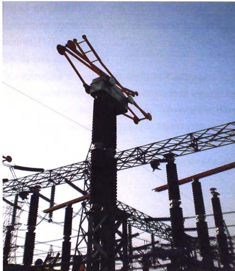
Figura 2.3 Seccionador - Chilca REP (Fuente elaboración propia).
