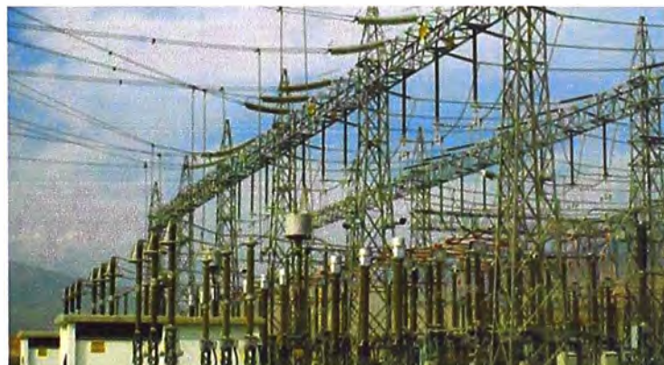
Figura 3.9 Imagen de las bahías de la subestación Chilca REP (Fuente: Elab. Propia)
