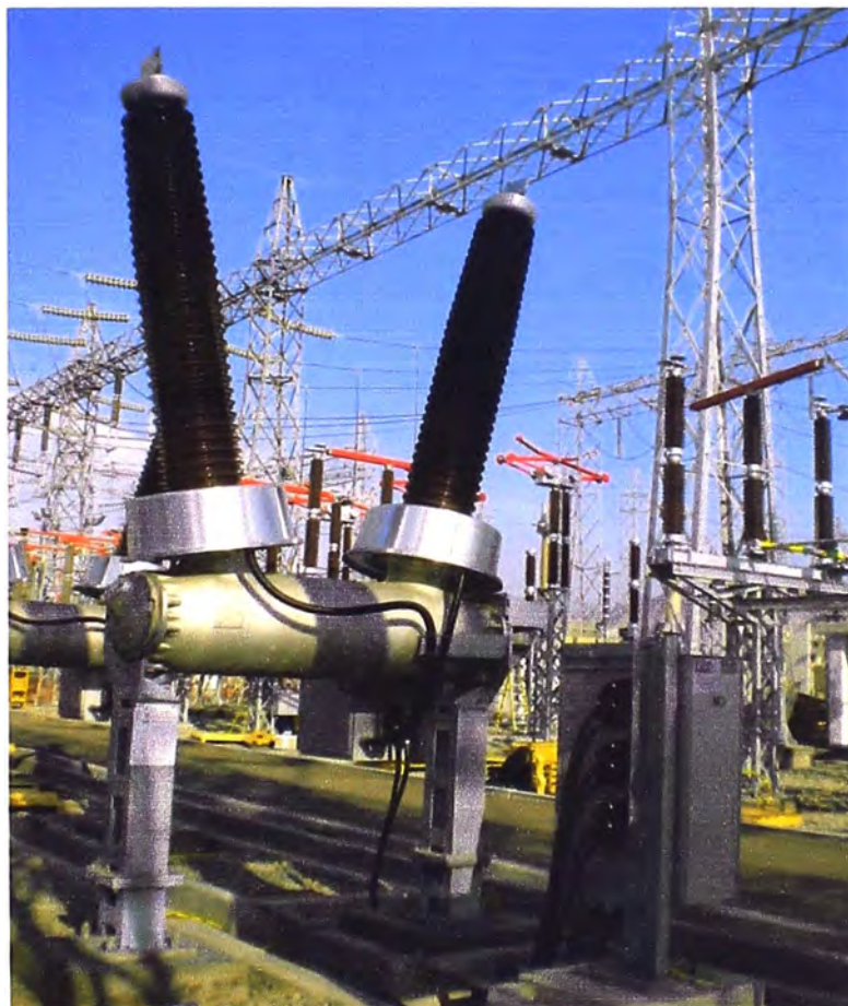
Figura 2.2 Interruptor de potencia - Chilca REP (Fuente elaboración propia).
