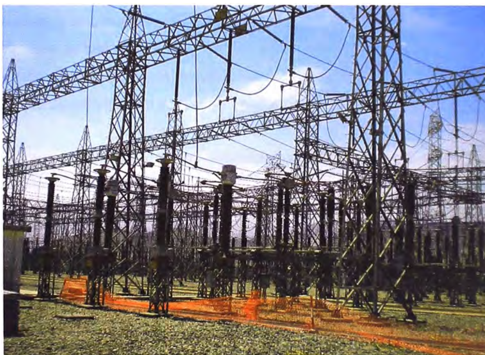
Figura 2.1 Subestación Chilca REP (Fuente elaboración propia).
