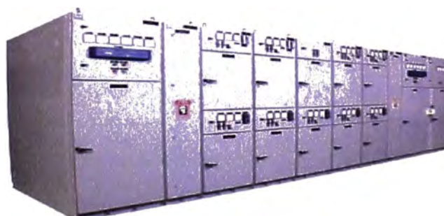
Fig. 2.4 Centro de Control de Motores en 4.16 kV
