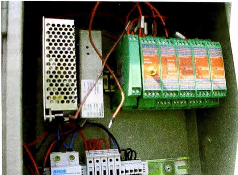
Figura 3.23 Detalle de módulo GSM/GPRS instalado
