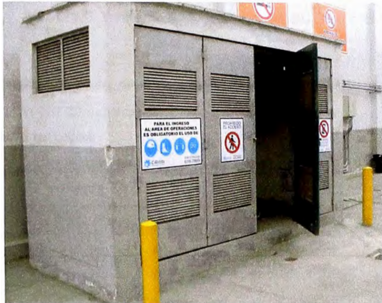
Figura 3.25 Estación de regulación y medición (ERM)
