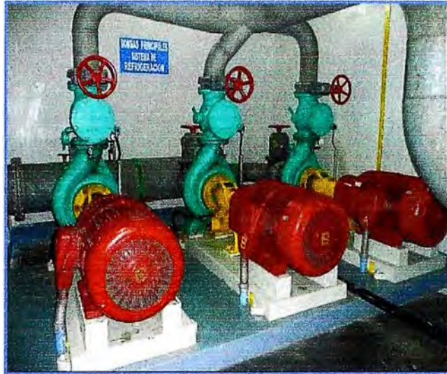
Fig. 4.7. Bombas del sistema de refrigeración principal
