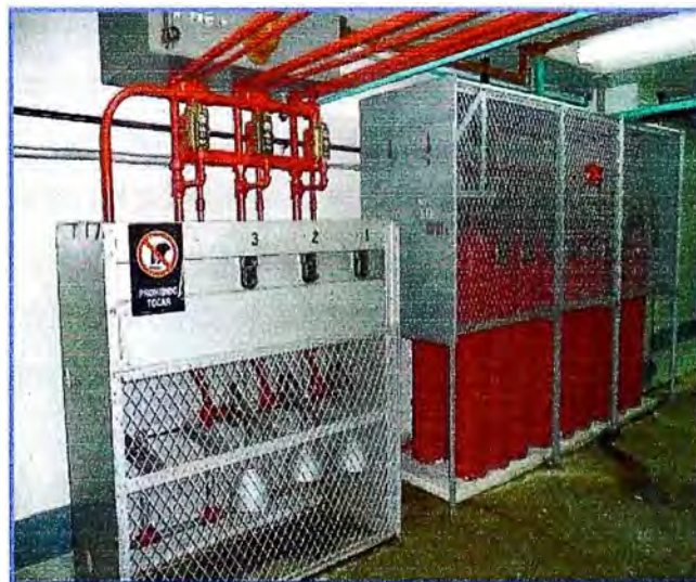
Fig. 4.9. Sistema Contra incendios
