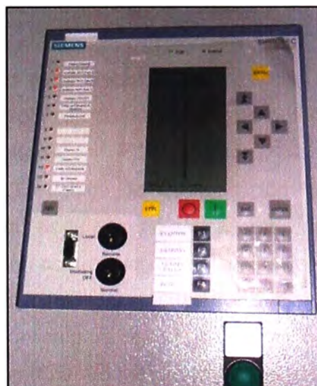
Figura 1.3 Control de la Subestación desde el Controlador de bahía
