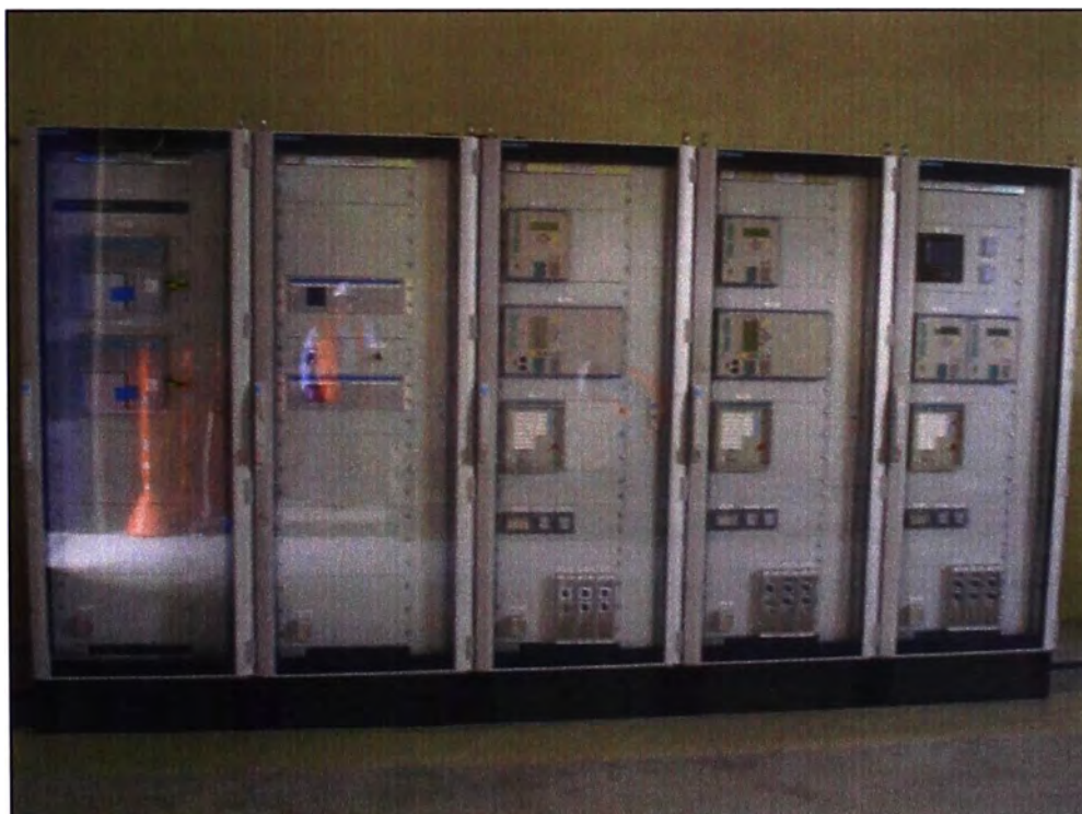
Figura 2.4 Tableros de Control y Protección S.E. Grau 60 kV.
