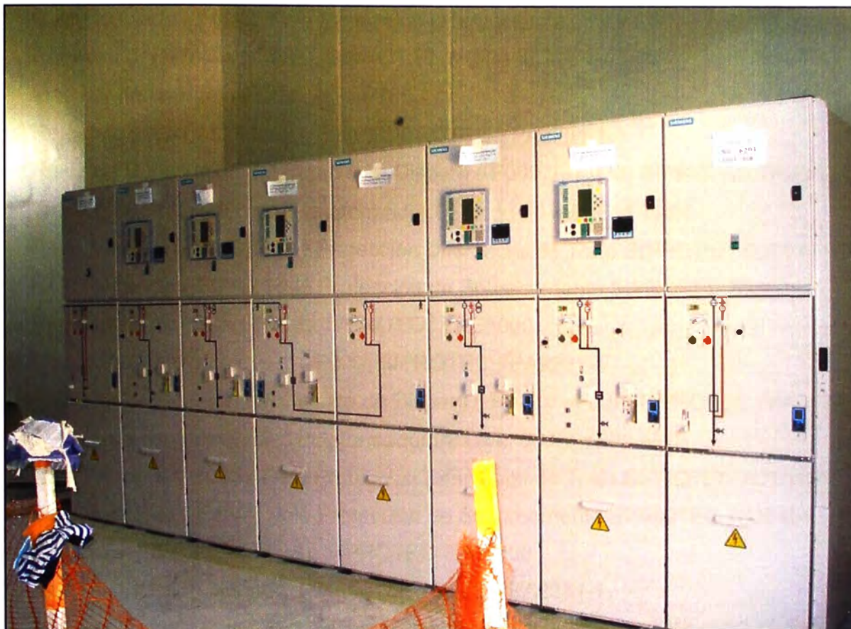
Figura 2.3 Celdas de Media tensión NXPLUS 24 kV - S.E. Grau.
