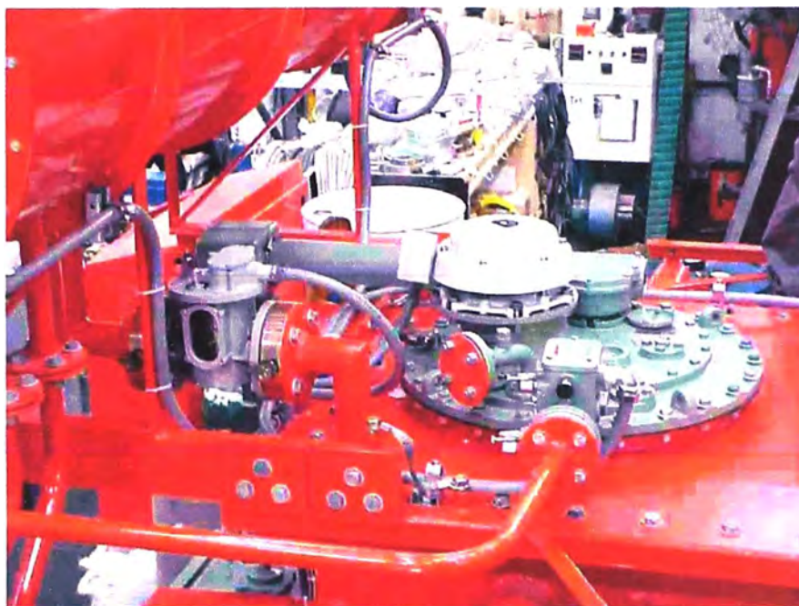
Fig. 1.7 Muestra de la ubicación de la válvula de seguridad
