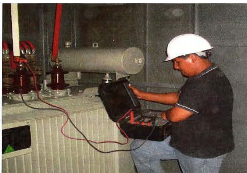
Fig. 3.2 Medición del aislamiento en interior (megometro Mi 10KVe megabras)
