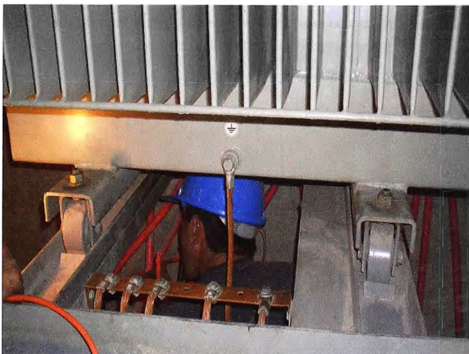
Fig. 3.1 Aterramiento del transformador
