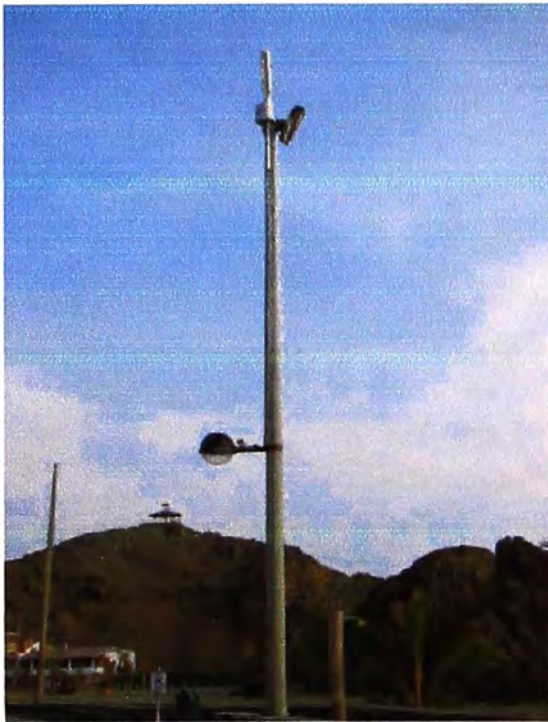
Vista del Poste que alberga los equipos
