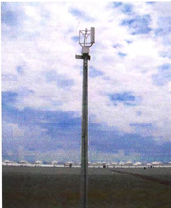
Vista de Poste que alberga los equipos
