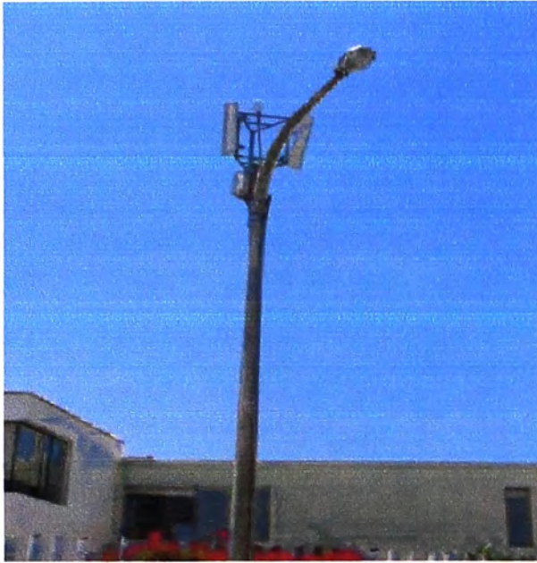
Vista del Poste que alberga los equipos
