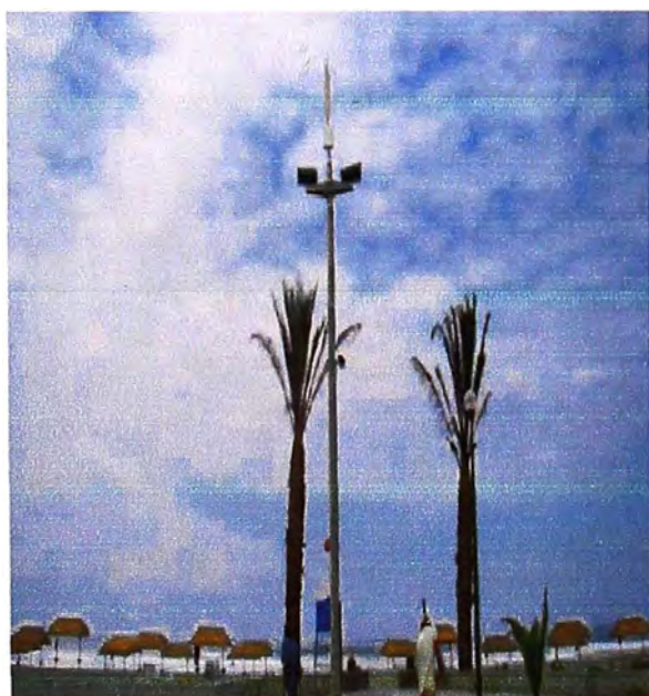
Vista del Poste que alberga los equipos
