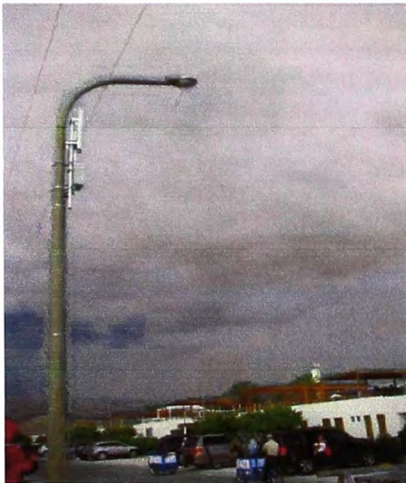
Vista del Poste que alberga los equipos
