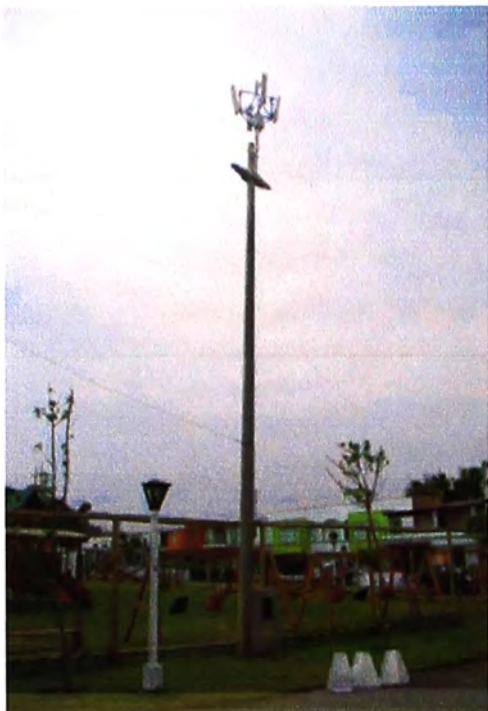
Vista del Poste que alberga los equipos
