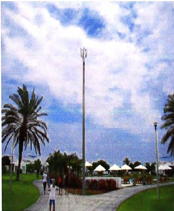
Vista de Poste que alberga los equipos
