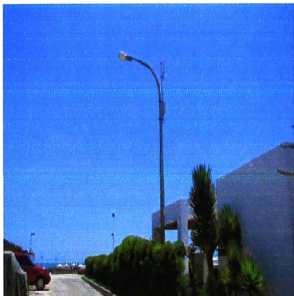
Vista del Poste que alberga los equipos
