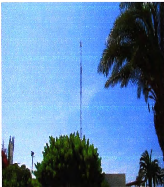
Vista del Torre que alberga los equipos
