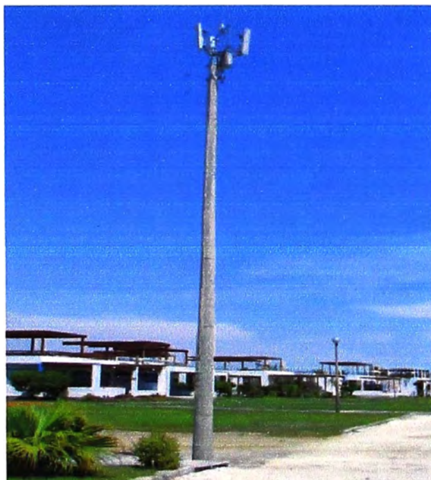
Vista del Poste que alberga los equipos
