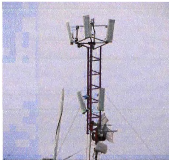
Detalle de equipos sectoriales
