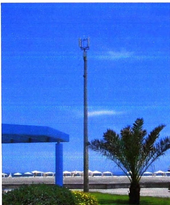
Vista del Poste que alberga los equipos
