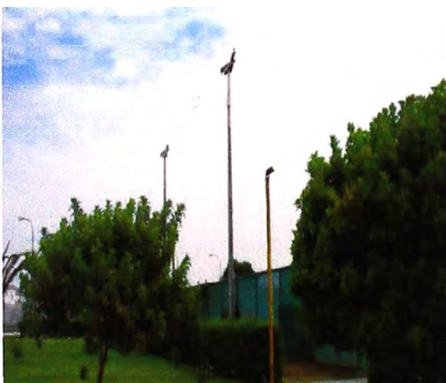
Vista del Poste que alberga los equipos
