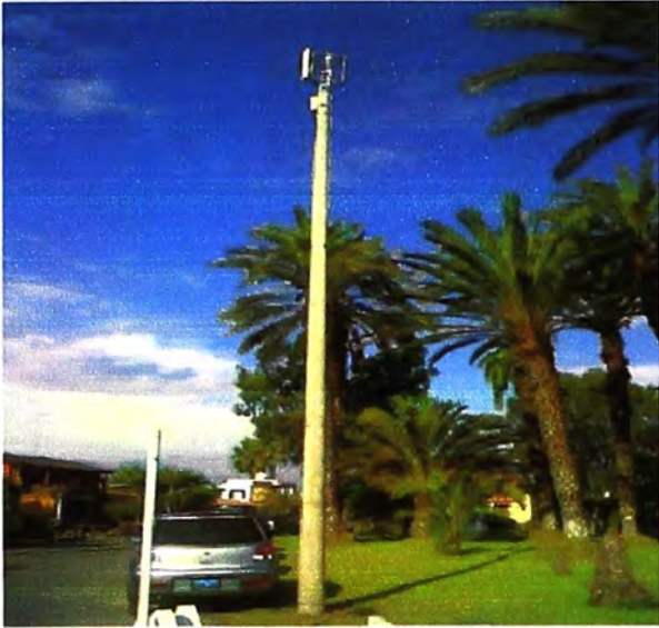
Vista del Poste que alberga los equipos
