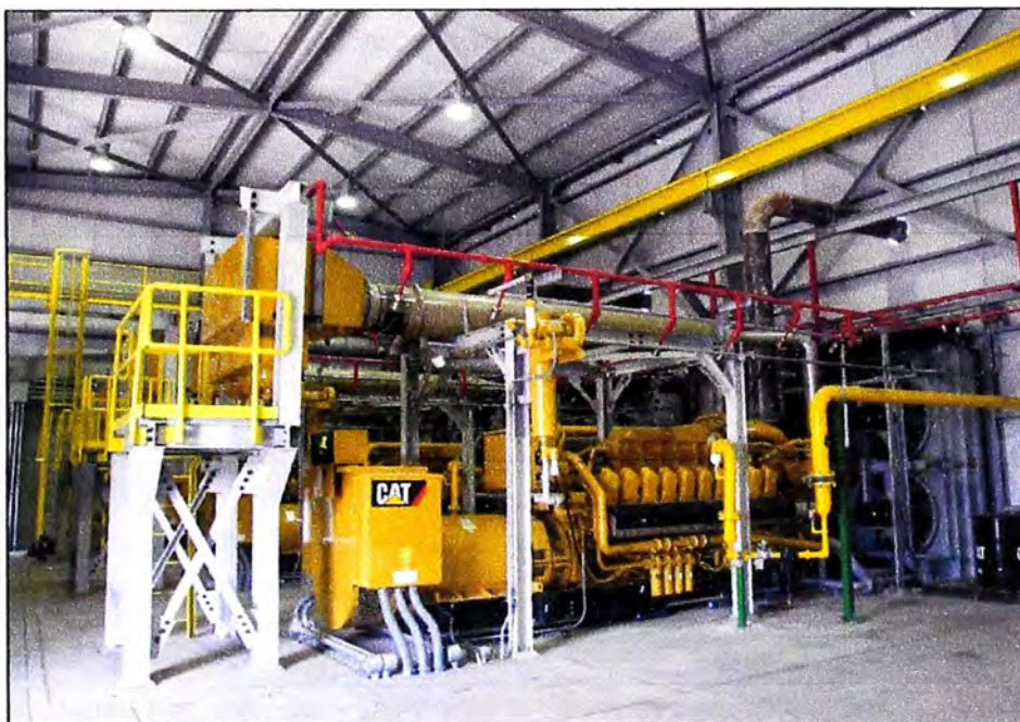
Figura 2.5 Grupo electrógeno Caterpillar en Central térmica Funsur (Fuente: Elaboración Propia).
