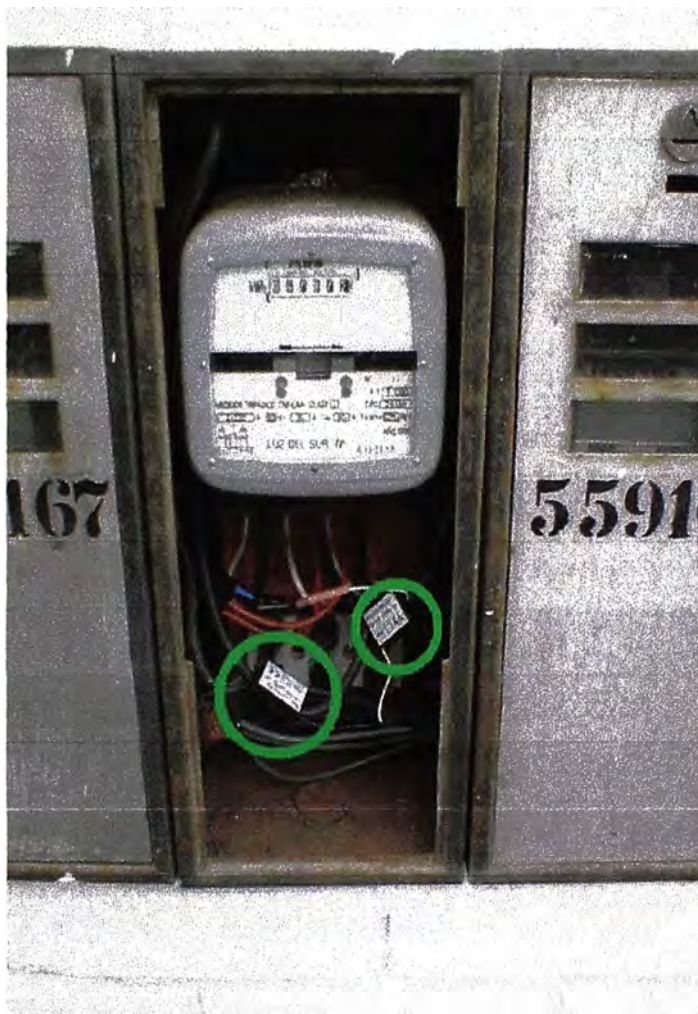
Figura 3. 7 Acopladores inductivos BPL en Medidor de Energía
